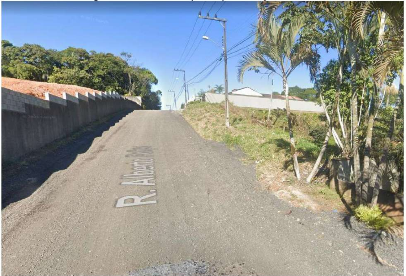
Figura 41- Rua Alberto Felipe sem pavimentação asfáltica.
