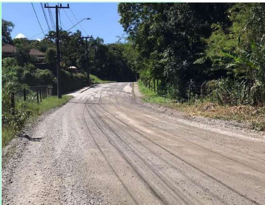
Figura 59 – Rua Anaburgo, trecho não pavimentado.
