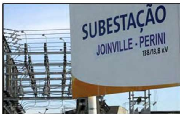
Figura 2.3: Subestação Joinville – Perini.
