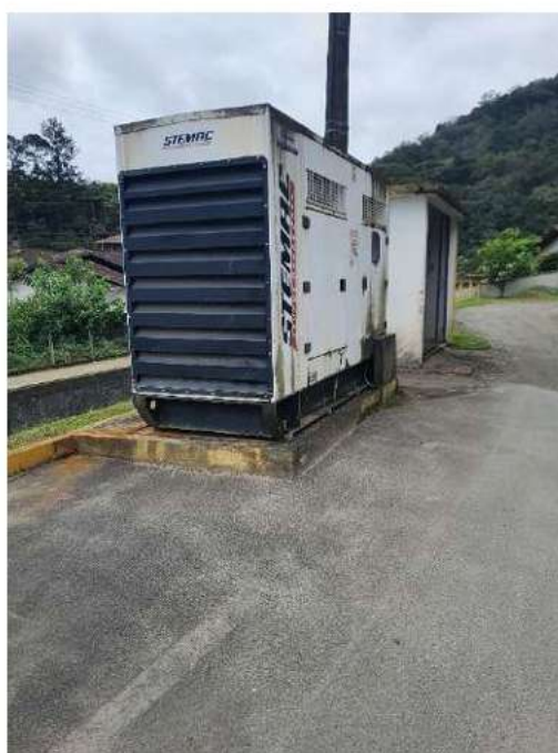
Foto 56: Gerador para emergências
