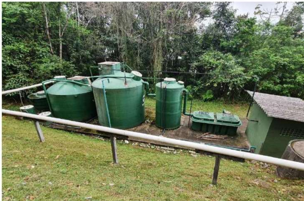
Foto 54: Estação de Tratamento de Efluentes do empreendimento
