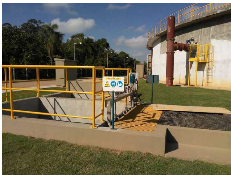
Figura 32: Unidade de desinfecção por ultravioleta
