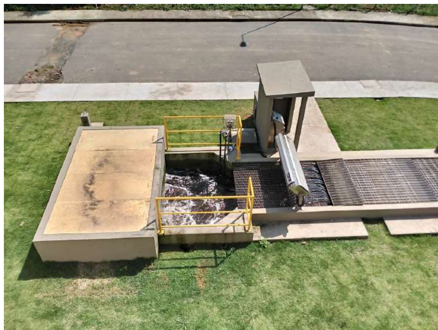
Figura 31: Unidade de desinfecção por ultravioleta
