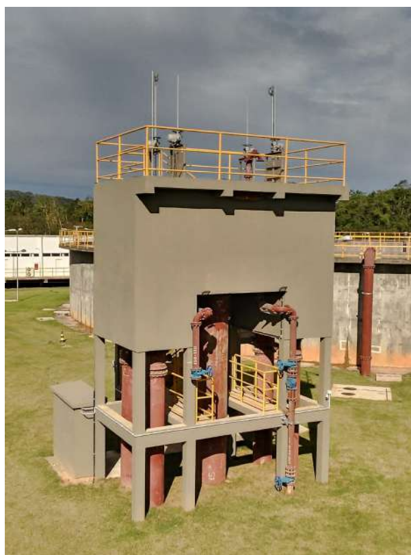
Figura 24: Tanque de distribuição
