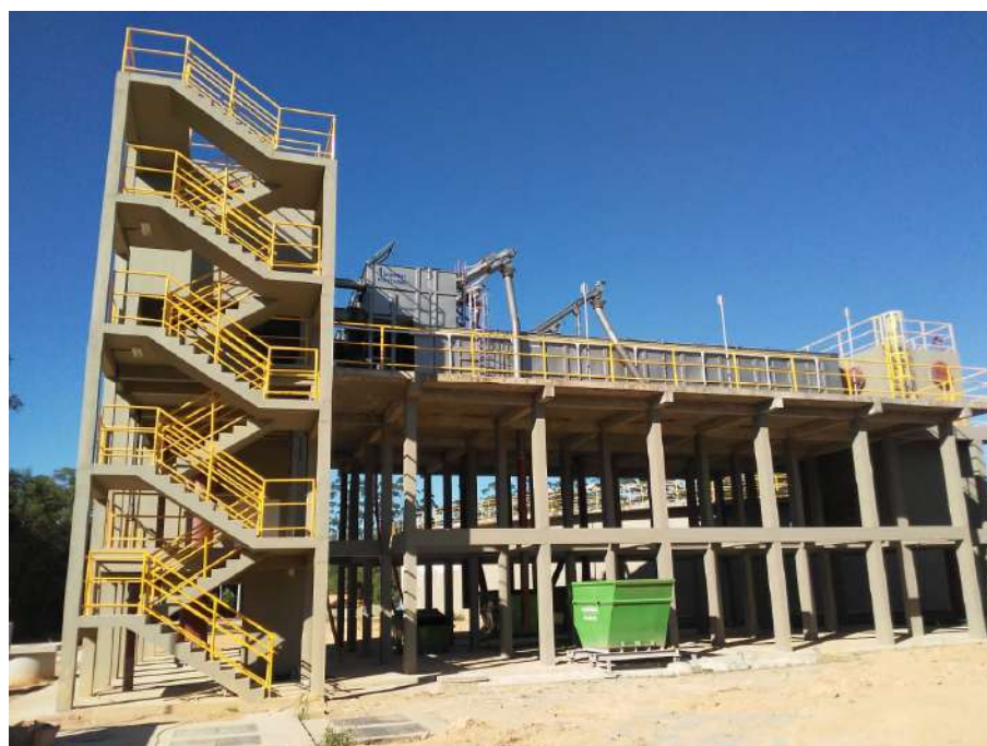
Figura 34: Unidade de tratamento preliminar
