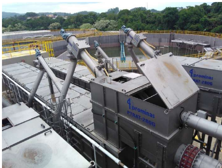
Figura 35: Unidade de tratamento preliminar
