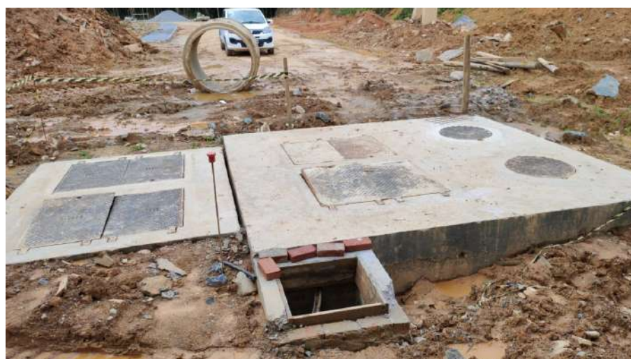
Figura 38: Elevatória de recalque
