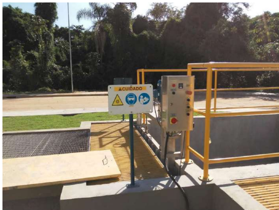
Figura 33: Unidade de desinfecção por ultravioleta
