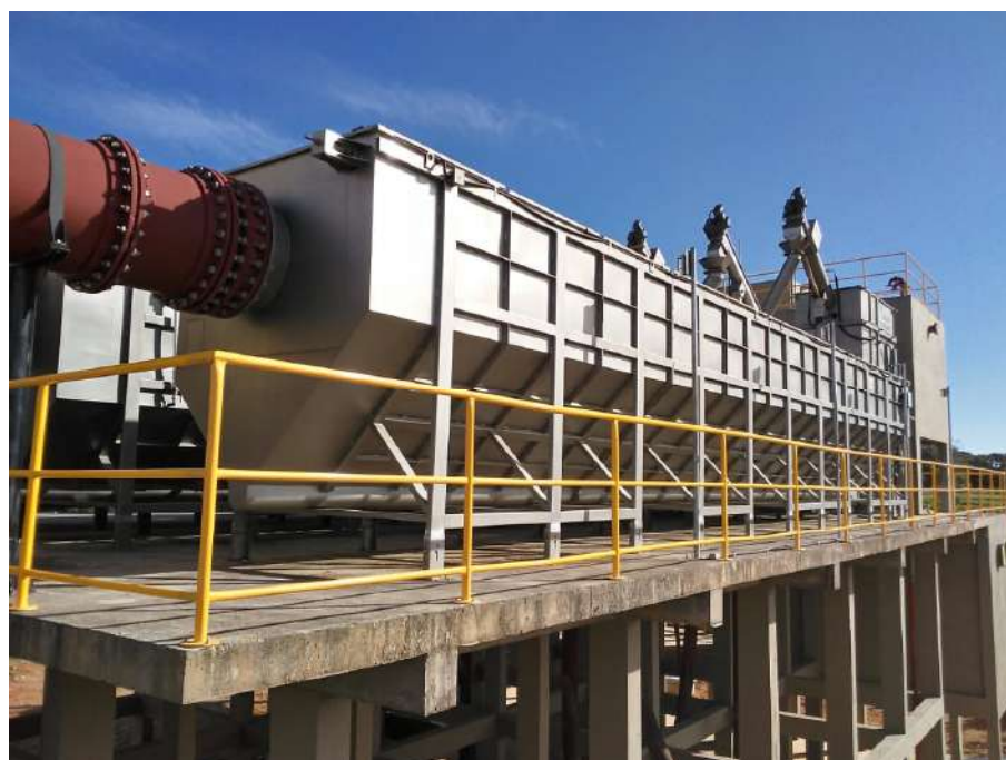
Figura 36: Unidade de tratamento preliminar
