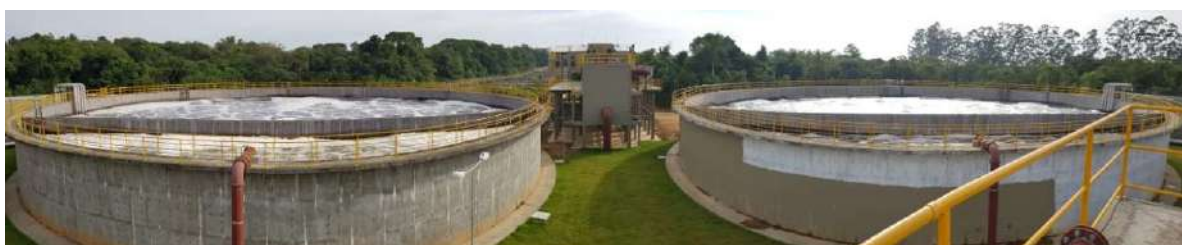
Figura 22: Reatores da ETE Jarivatuba
