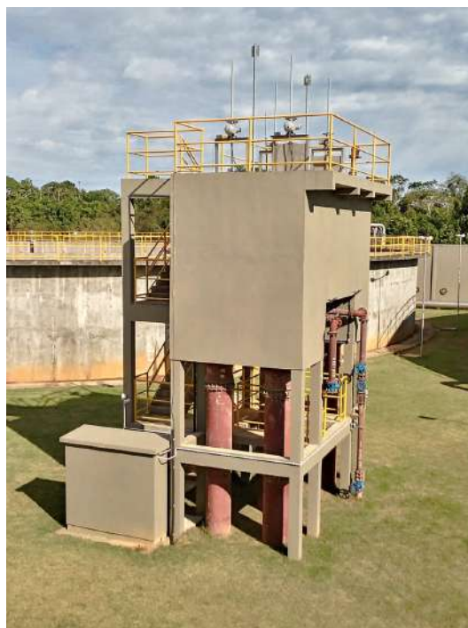
Figura 25: Tanque de distribuição
