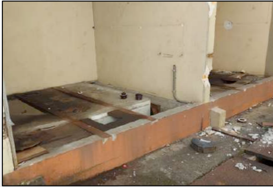
Fotografia 21: AS-7- Antigos transformadores. Fonte: AUTOR, 2021.
