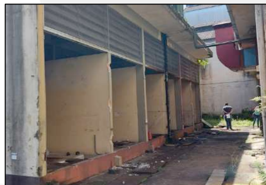
Fotografia 20: AS-7- Antigos transformadores. Fonte: AUTOR, 2021.
