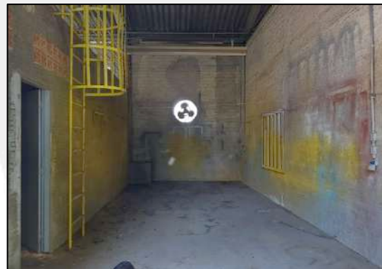
Fotografia 18: AS-3- Estufa de pintura/depósito de tintas. Fonte: AUTOR, 2021.
