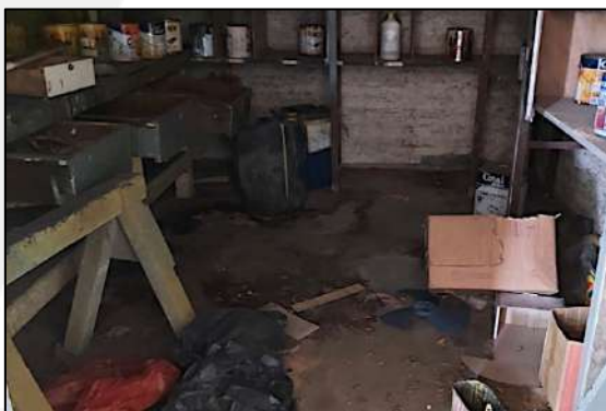
Fotografia 19: AS-3- Estufa de pintura/depósito de tintas. Fonte: AUTOR, 2021.
