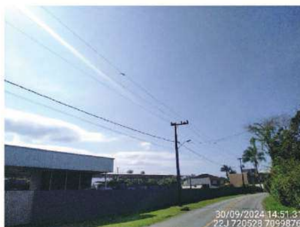
Figura 21 – Poste de iluminação pública em frente ao empreendimento.
