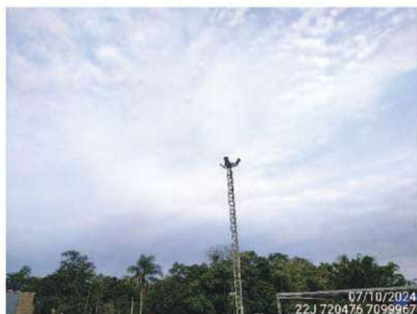
Figura 22 – Poste de iluminação localizada no estacionamento do empreendimento.
