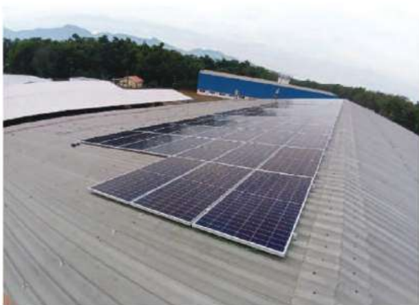
Figura 24 – Painéis solares no empreendimento.
