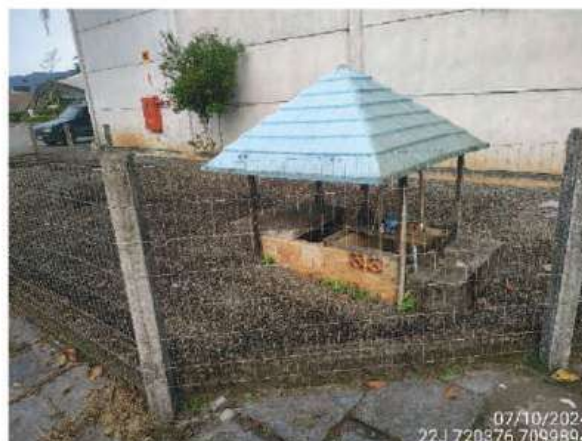
Figura 27 – Sistema de bombeamento.
