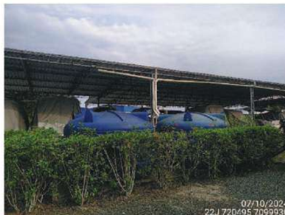
Figura 29 – Sistema de captação e reservação de água da chuva.
