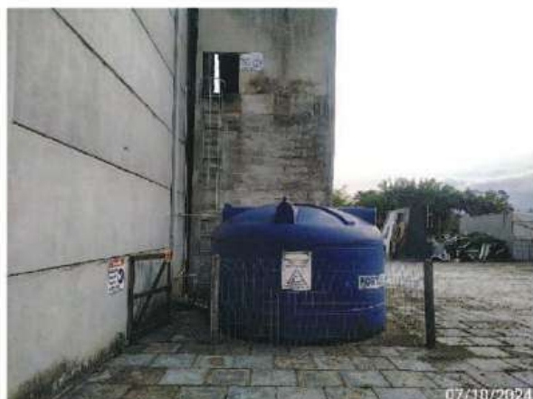
Figura 26 – Reservatório de água da chuva.
