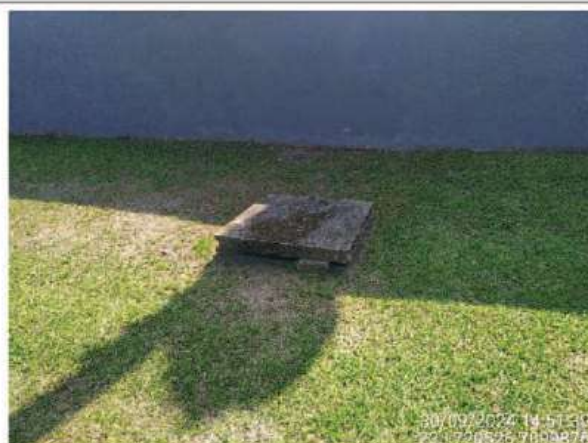
Figura 19 - Caixa de passagem na área externa do empreendimento.
