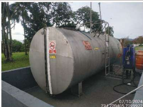
Figura 38 - Tanque de abastecimento de embarcações
