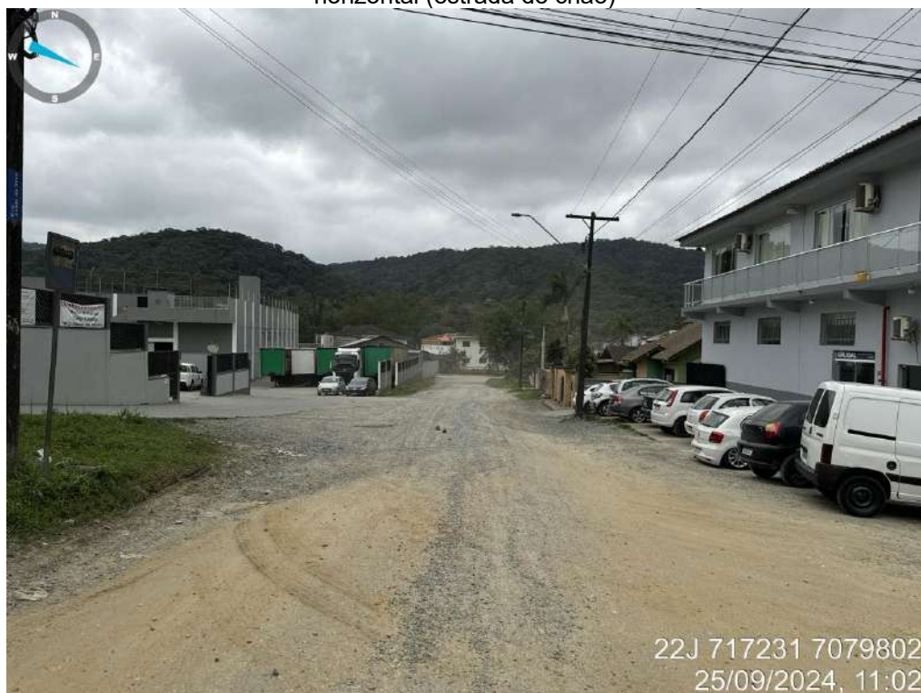
Figura 25. Registro fotográfico da Rua Arildo da Silva apresentando ausência de sinalização vertical e horizontal (estrada de chão)
