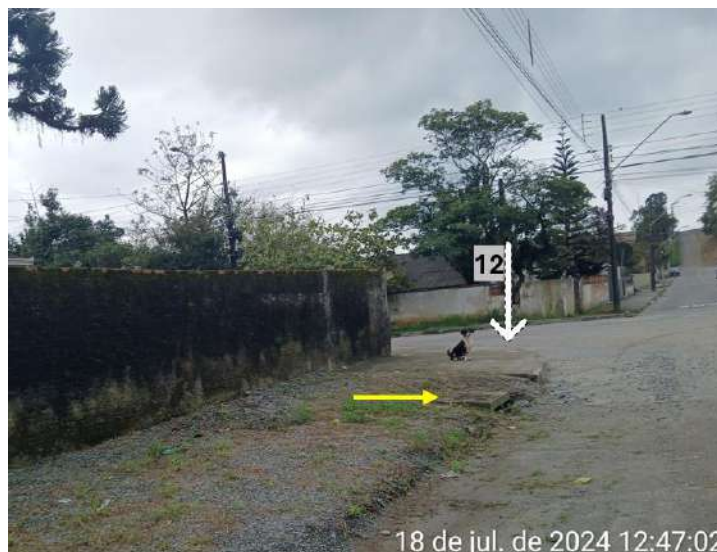
Figura 52: Boca de lobo na rua Adelaide Serafim da Silva, próximo ao vértice 12.
