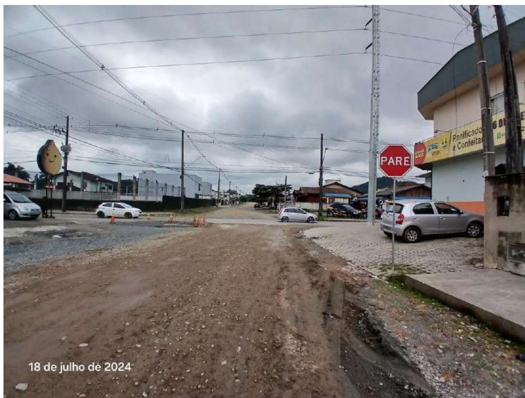
Figura 76: Rua Maria Lucimar Fritz, próximo ao cruzamento com a Rua Seis de Janeiro.
