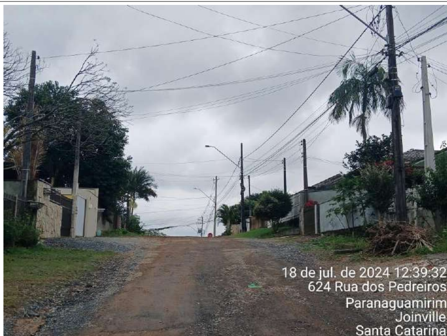
Figura 7: Postes de iluminação pública rua dos Pedreiros.
