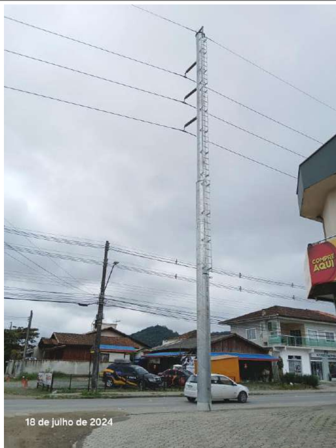
Figura 158: Poste instalado na rua 6 de janeiro, próximo à LD.
