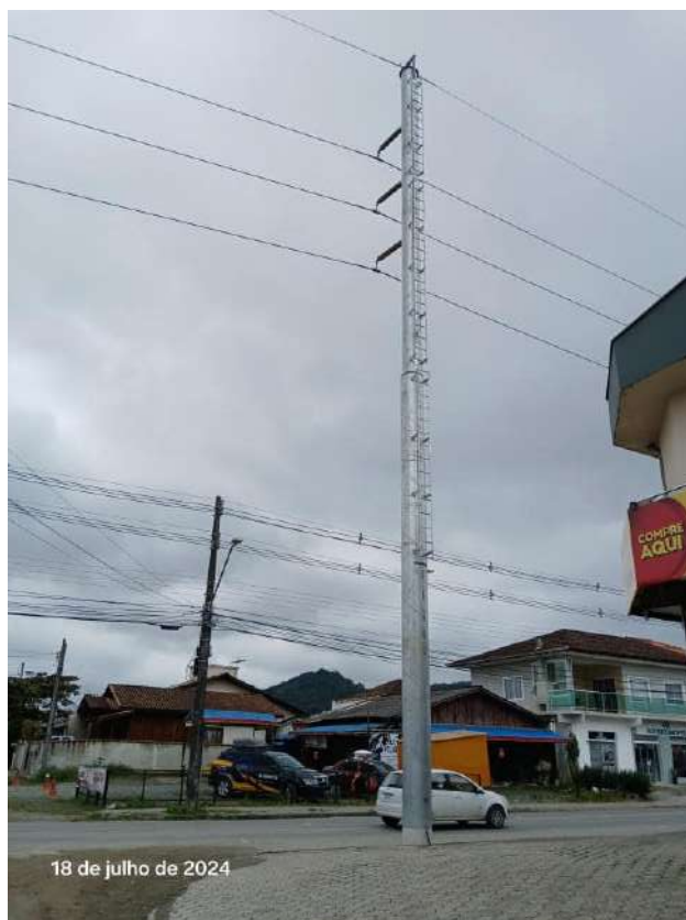
Figura 2: Poste de Linha de Alta Tensão 138kV Boa Vista – Paranaguamirim, rua 06 de janeiro.
