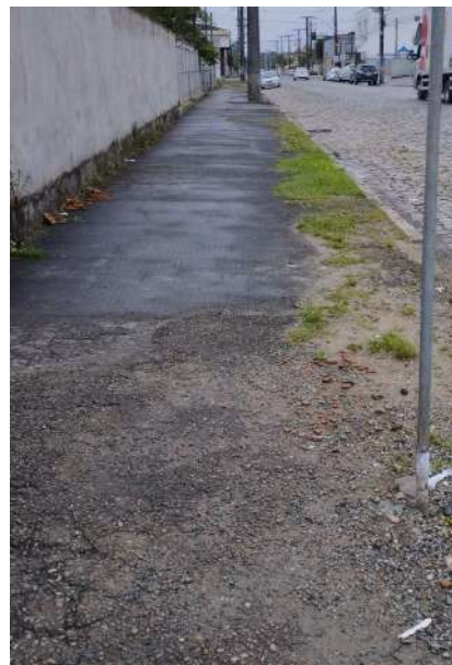
Calçada com pavimento danificado
