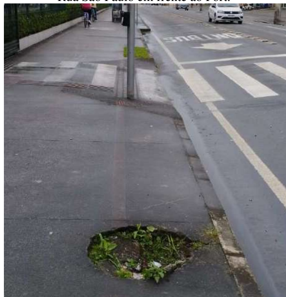
Buraco em calçada
