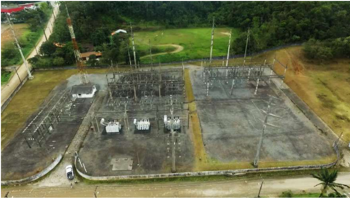
Figura 19: Ponto de chegada na SE Joinville Santa Catarina, de propriedade da CELESC.
