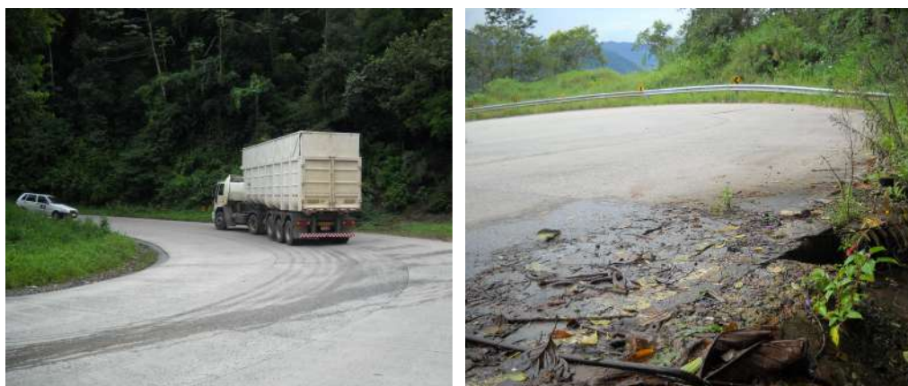
Figura 45 e 46 – Surgência d'água sobre a pista.
