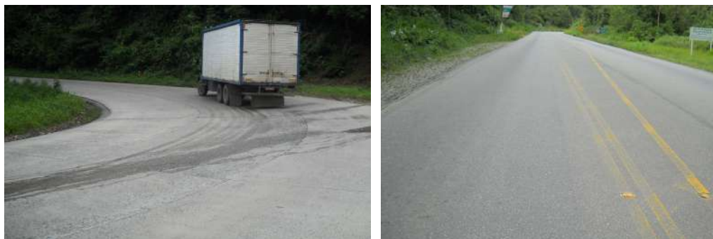
Figura 37 e 38 – Sinalização horizontal inexistente ou falha em trecho de alta criticidade.
