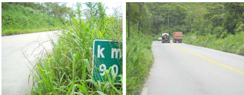
Figura 39 e 40 – Sinalização vertical encoberta pela vegetação.
