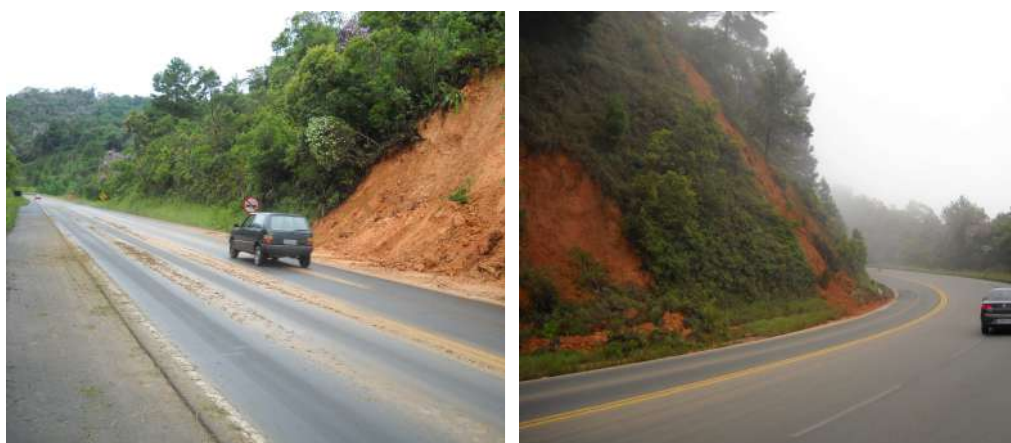
Figura 43 e 44 – Pontos críticos com deslizamento de solo sobre o pavimento.
