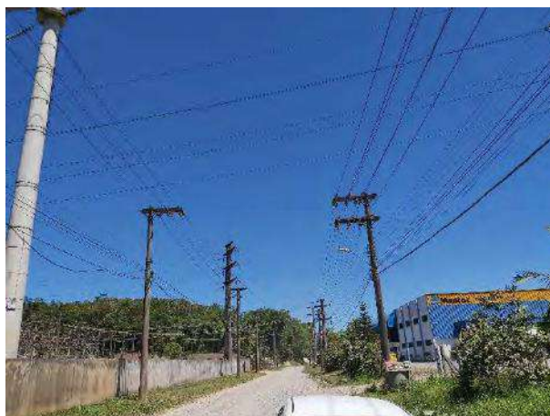
Figura 55: Postes no entorno da subestação Joinville Santa Catarina.
