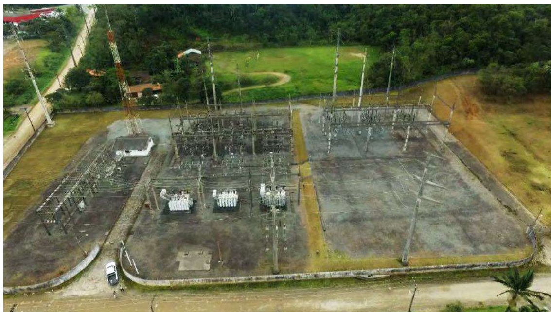
Figura 12: Ponto de chegada na SE Joinville Santa Catarina, de propriedade da CELESC.
