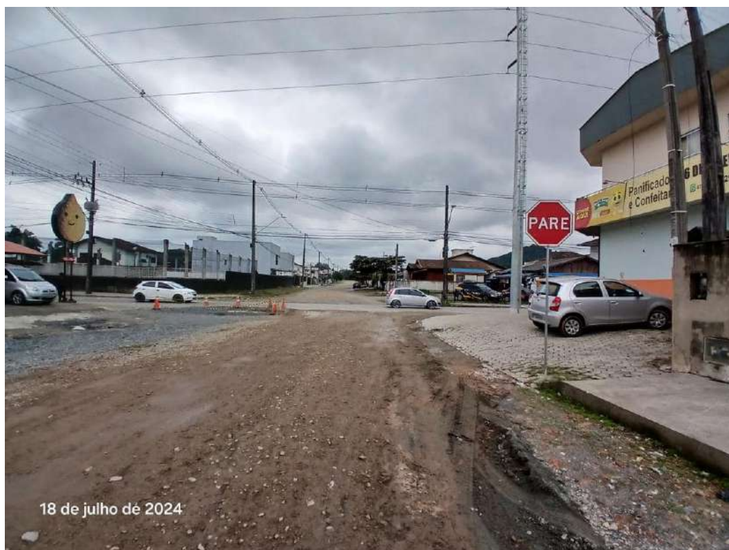
Figura 72: Rua Maria Lucimar Fritz, próximo ao cruzamento com a Rua Seis de Janeiro.
