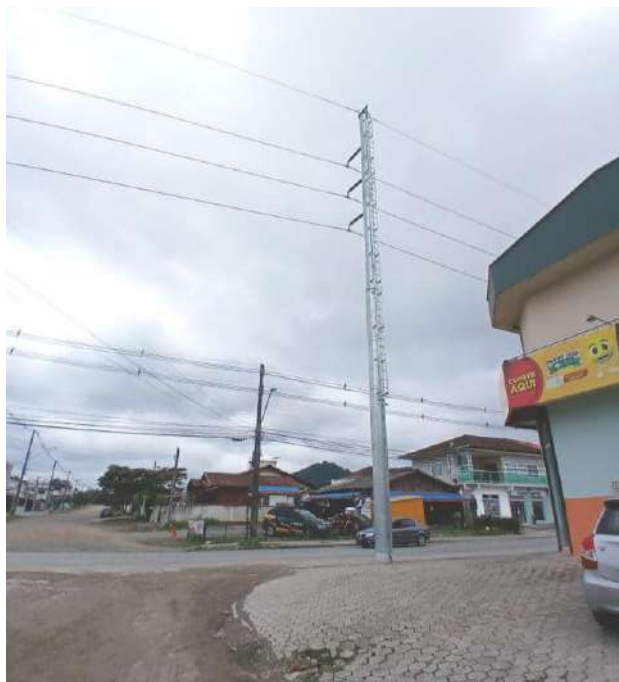
Figura 19: Poste de Linha de Alta Tensão 138kV Boa Vista – Paranaguamirim, rua 06 de janeiro, esquina com rua Maria Lucimar Fritz.
