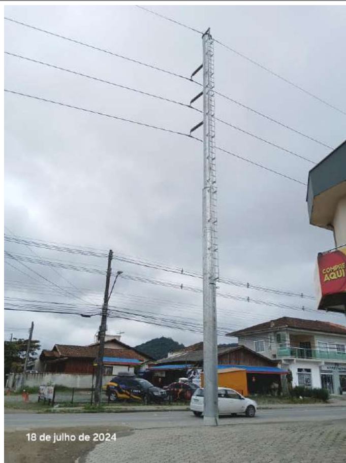
Figura 156: Poste instalado na rua 6 de janeiro, próximo à LD.
