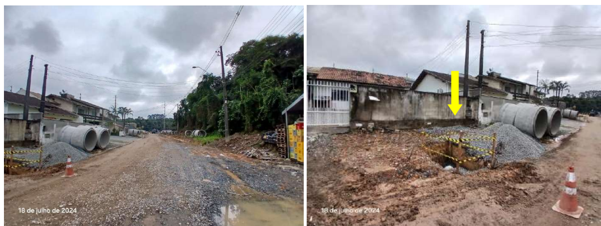
Figura 23: Rua Maria Lucimar Fritz, vértice 05, vista para subestação.
