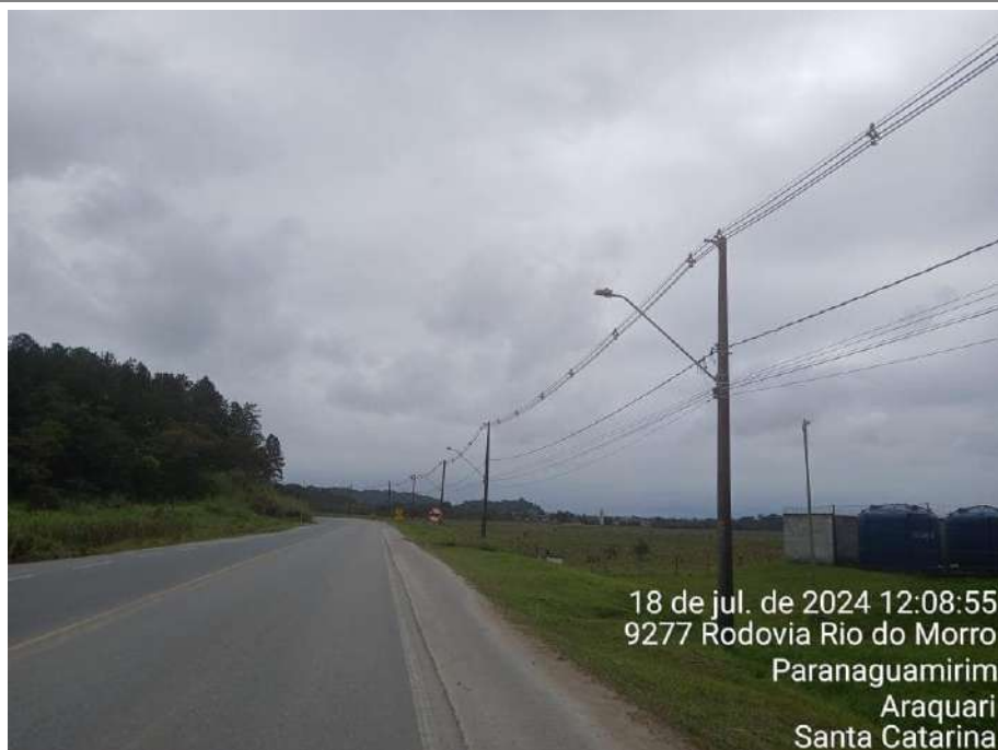
Figura 68: Postes de iluminação pública na estrada Rio do Morro, entre vértices 26 e 27.
