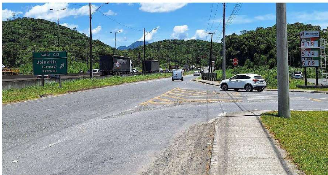
Figura 12 – Condição da sinalização horizontal
