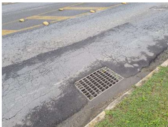
Figura 17 - Boca de lobo em frente ao empreendimento
