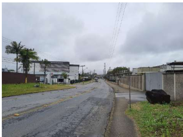
Figura 13 - Situação da pavimentação no sentido o leste - oeste
