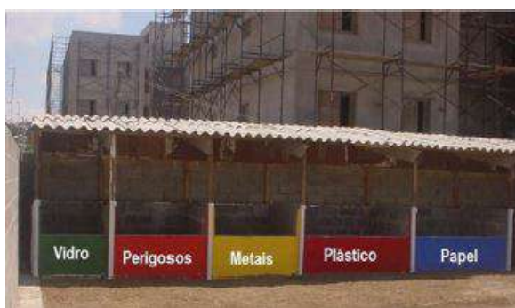
Figura 6-1 - Exemplo de Baias para os resíduos da Obra.
