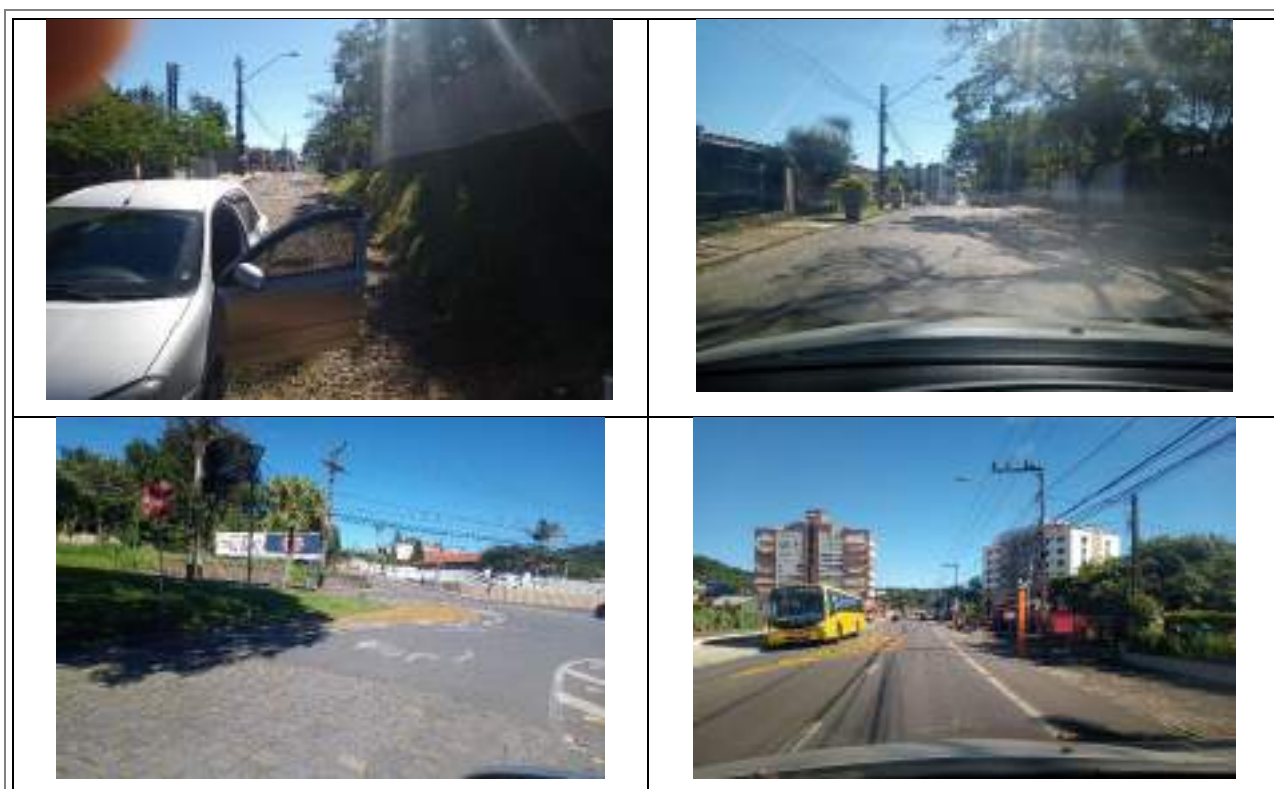
Figura 19 - Condições da pavimentação.
