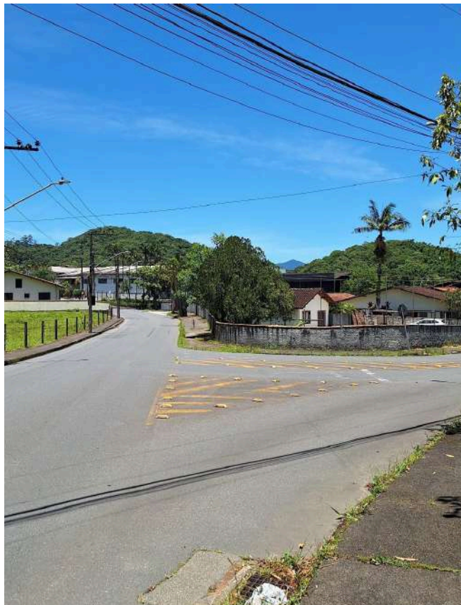
Figura: Falhas na pintura da intersecção entre a Rua Colon e Rua Angelo Storrer. Fonte: M.URB, 2023.
