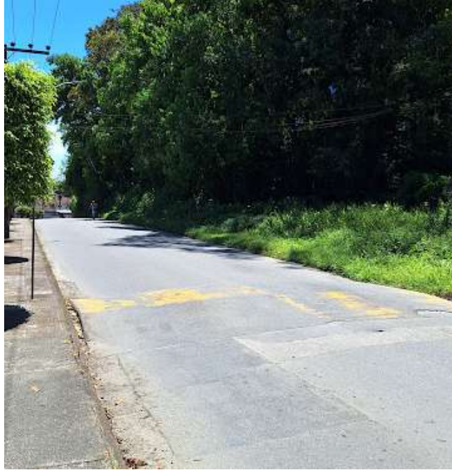
Figura: Falhas na pintura na lombada da Rua Colon. Fonte: M.URB, 2023.
