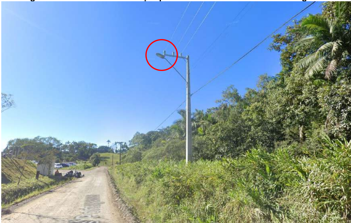
Figura 43 - Sistema de iluminação pública localizada na Rua dos Portugueses
