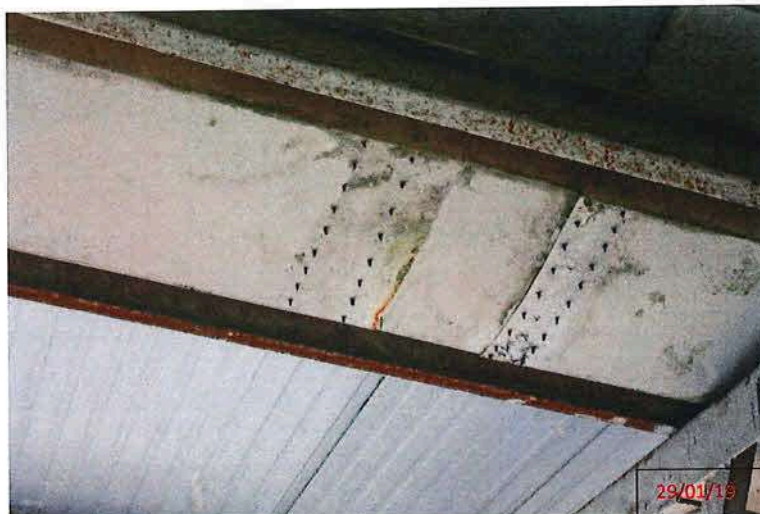
Foto 24- Calha com vazamento
