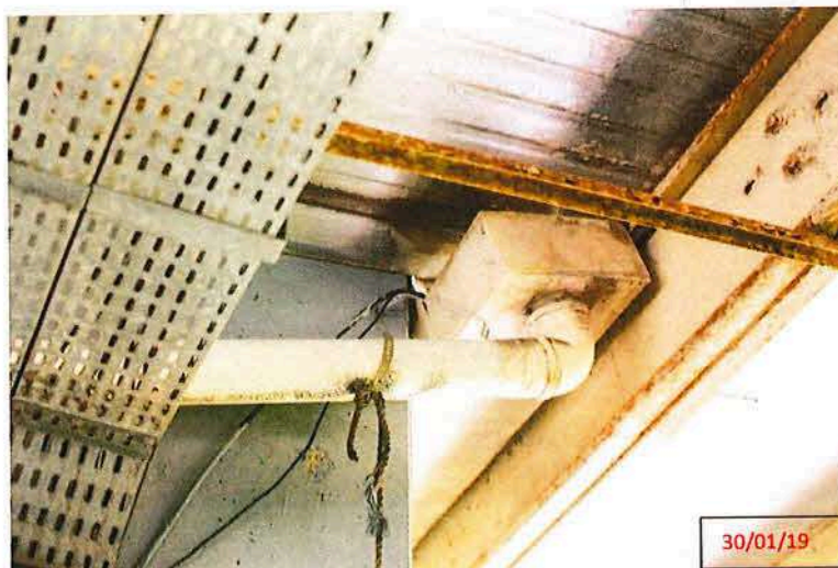
Foto 25 – Calha sem fixação adequada
