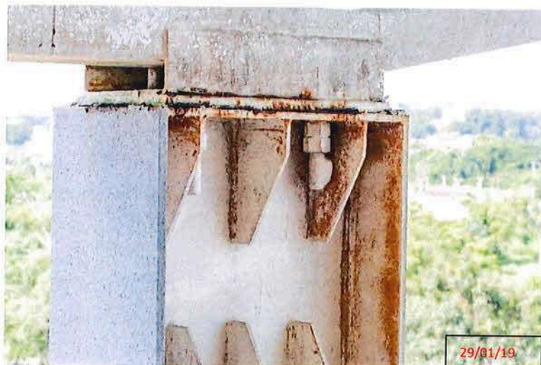
Foto 4-Corrosão nos apoios
