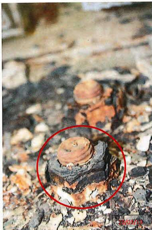
Foto 6- Delaminação das porcas de junção das tesouras
