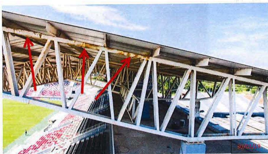
Foto 7- Oxidação na parte externa da tesoura no banzo superior (corrosão uniforme)
