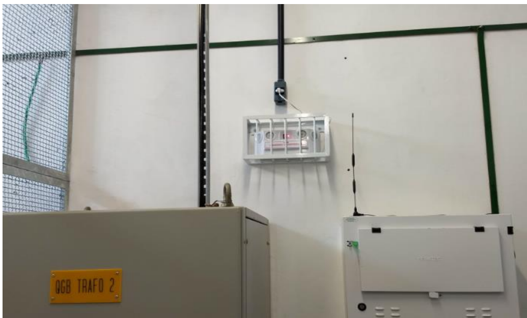
Foto 37 – Bloco Autônomo de Iluminação de Emergência na Subestação-01/12/2020
