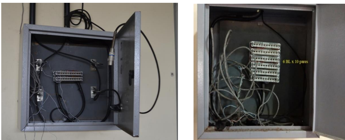
Foto 43 - Quadros Setoriais de Telefonia, Cabeamentos e Blocos de conexão 01/12/2020
