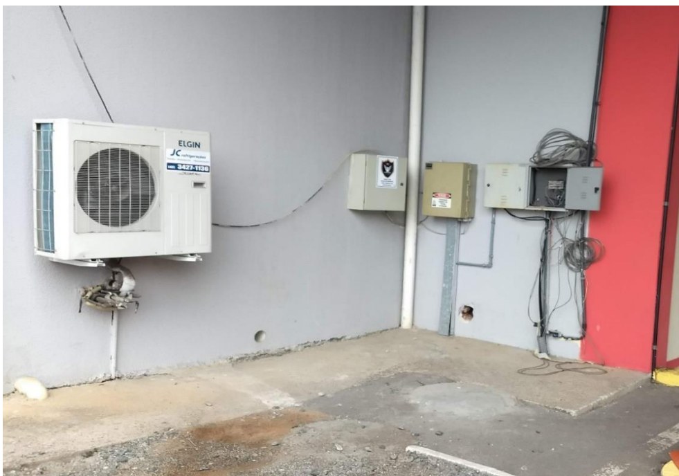
Foto 23 – Aparelho de Ar Condicionado Split no Térreo – 01/12/2020
