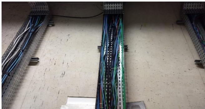
Foto 21 – Eletrocalhas no interior de uma Sala de Painéis – 01/12/2020
