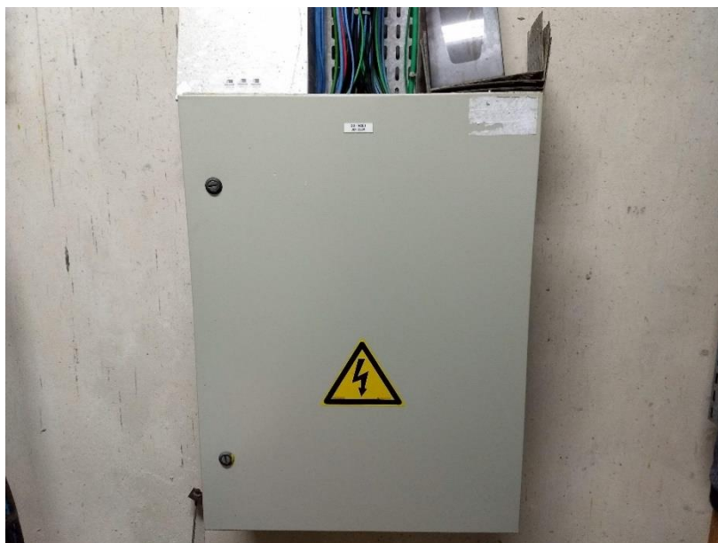
Foto 15 –Centro de distribuição em chapa de ferro com pintura em epoxy, na Sala de Painéis – 01/12/2020
