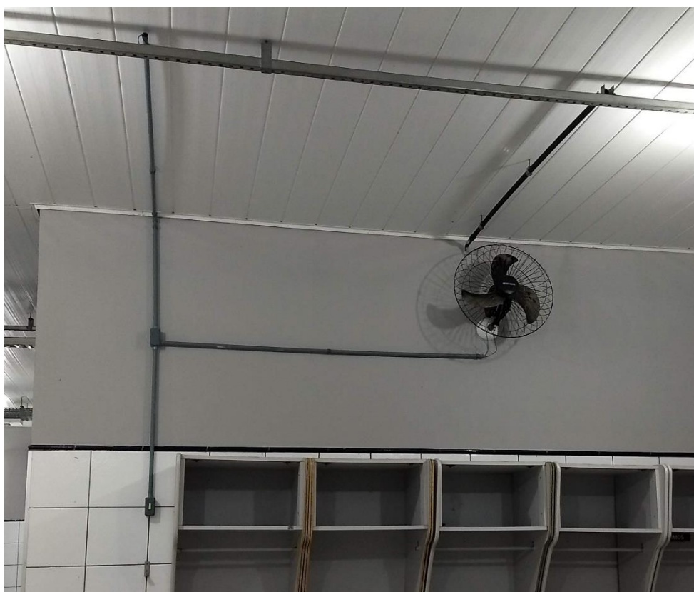
Foto 24 – Ventilador instalado no vestiário – 01/12/2020
