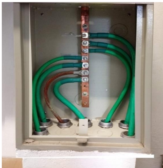
Foto 12 – Barramento de Equipotencialização de Potencial (BEP) 01/12/2020
