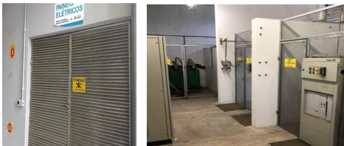
Foto 5 – Subestação abrigada incorporada à Edificação – 01/11/2020
