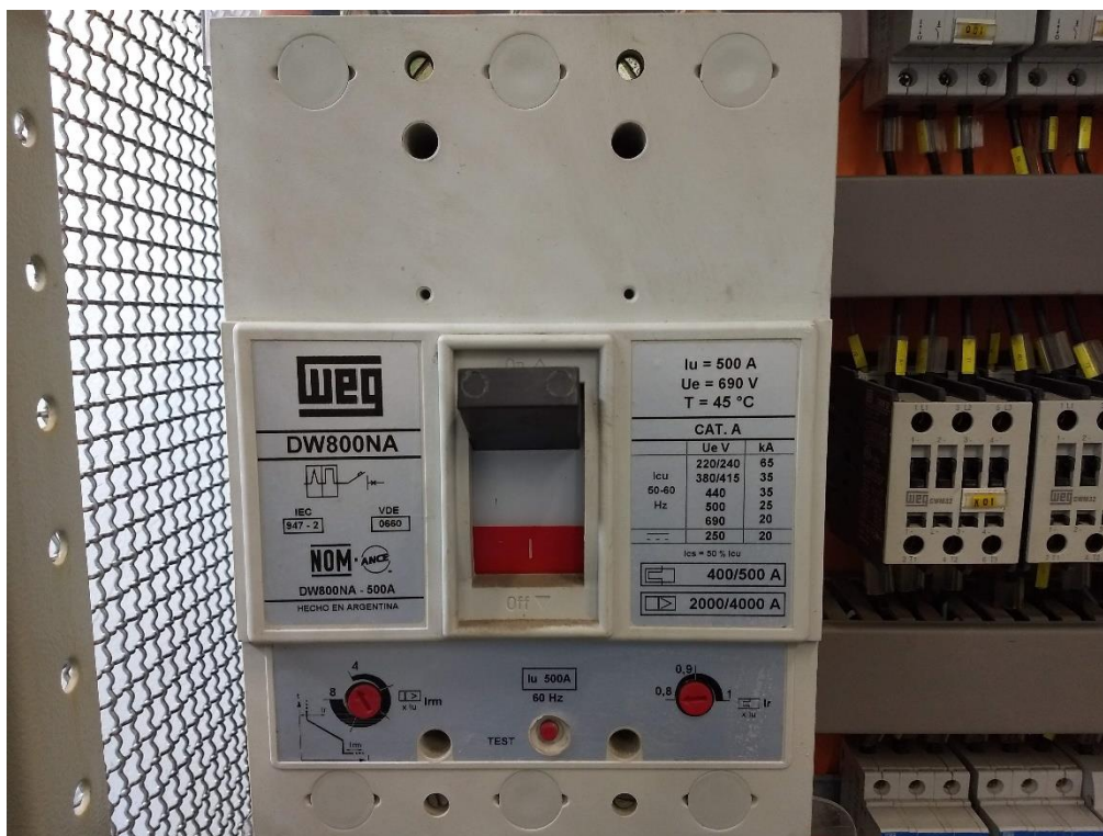
Foto 11 - Disjuntor Geral, de 500 A e contadores de iluminação no QGBT 2 da Subestação – 01/12/2020
