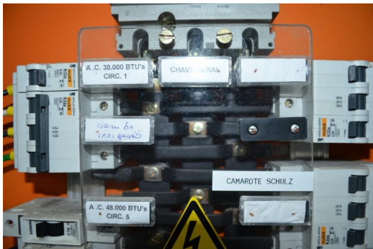
Foto 18 –Quadro com Disjuntor Geral, disjuntores de proteção de circuitos, para proteção do Sistema de Computadores – 01/12/2020
