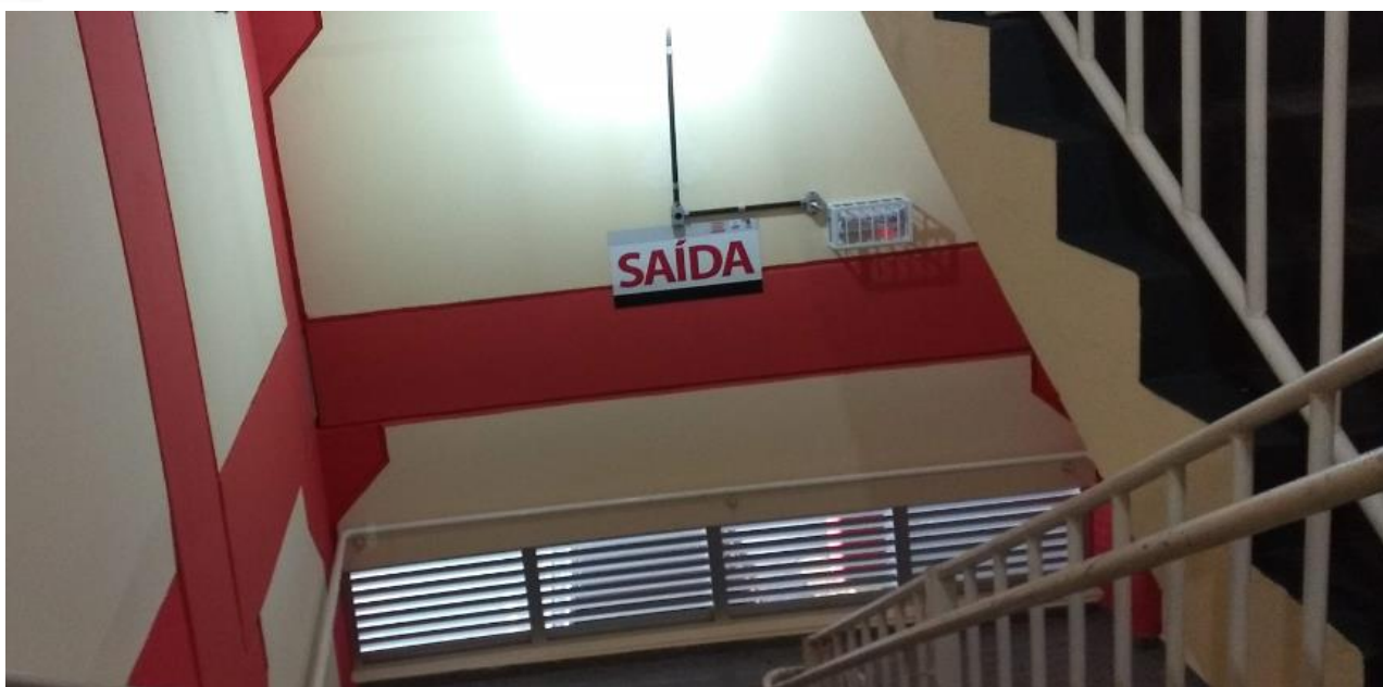
Foto 35 - Blocos Autônomos de Iluminação Emergência Saída na escadaria 01/12/2020
