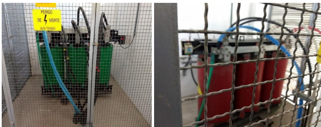
Foto 6 – Transformadores 1e 2 a seco de 300 kVA e 500 kVA – 01/11/2020
