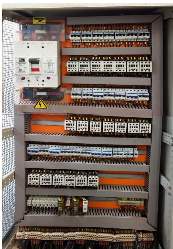
Foto 9 –QGBT 2 na Subestação – 01/12/2020
