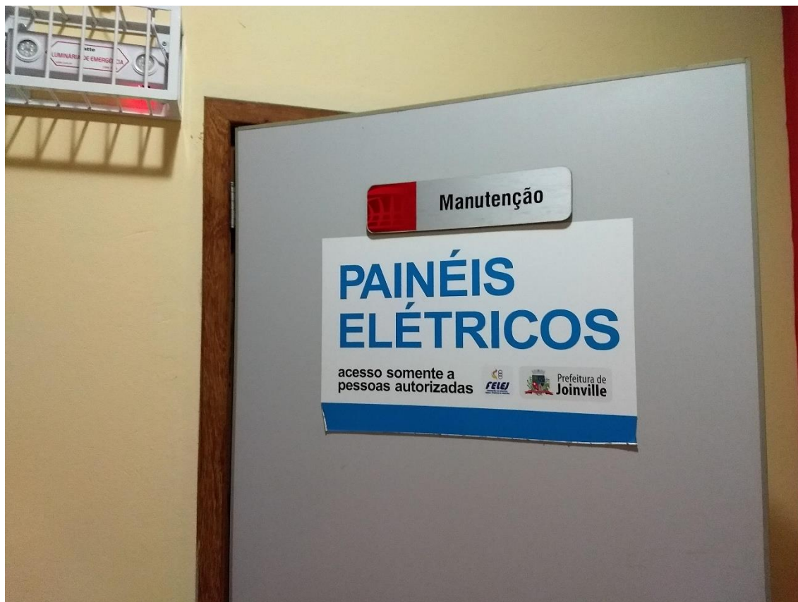
Foto 14 – Porta de entrada da Sala de Painéis no Setor Sul da Edificação 01/12/2020
