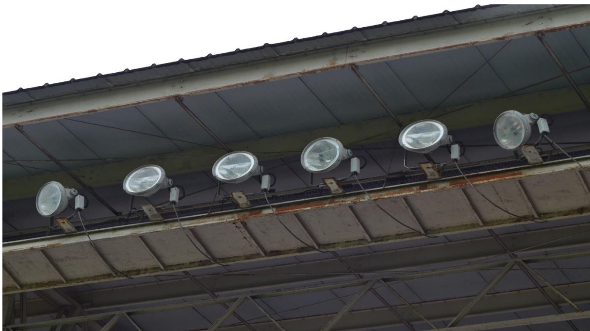
Foto 33 – Detalhe de conjunto de projetores de 2.000 W na Marquise 01/12/2020
