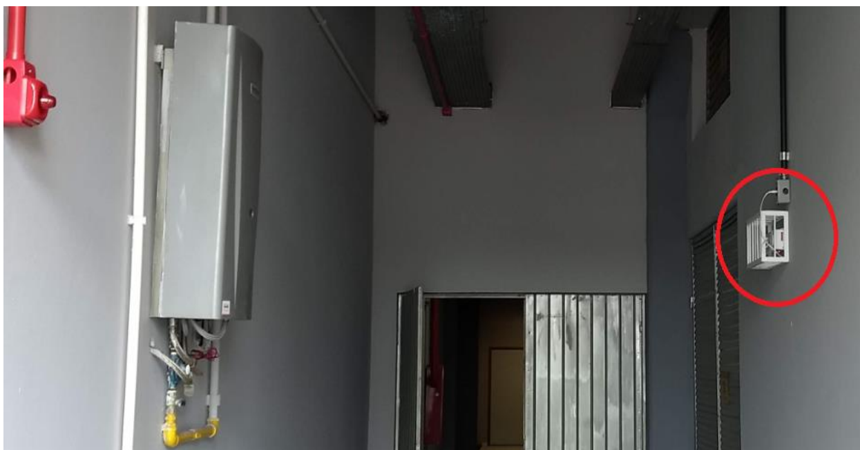
Foto 36 - Bloco de Iluminação Emergencial tipo LED Corredor Subestação 01/12/2020
