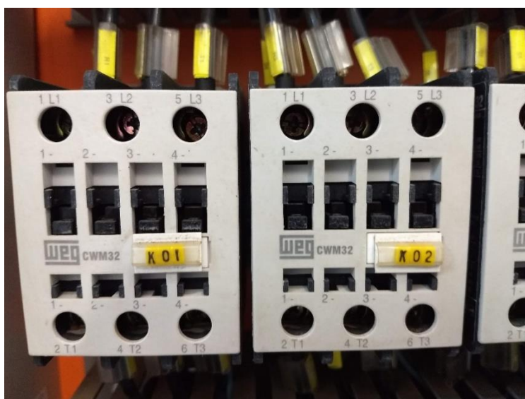
Foto 19 – Contadoras de acionamento da Iluminação do Campo de futebol, no Quadro Geral Nº 2, na Subestação – 01/12/2020
