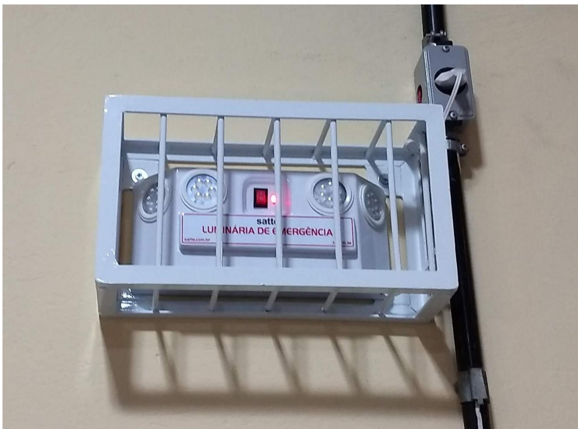
Foto 34 - Blocos Autônomos de Iluminação de Emergência com 4 faróis LEDS de 1.000 lumens- 01/12/2020
