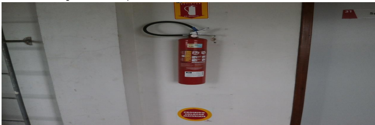
Foto 24 – sistema preventivo contra incêndio no Estádio
