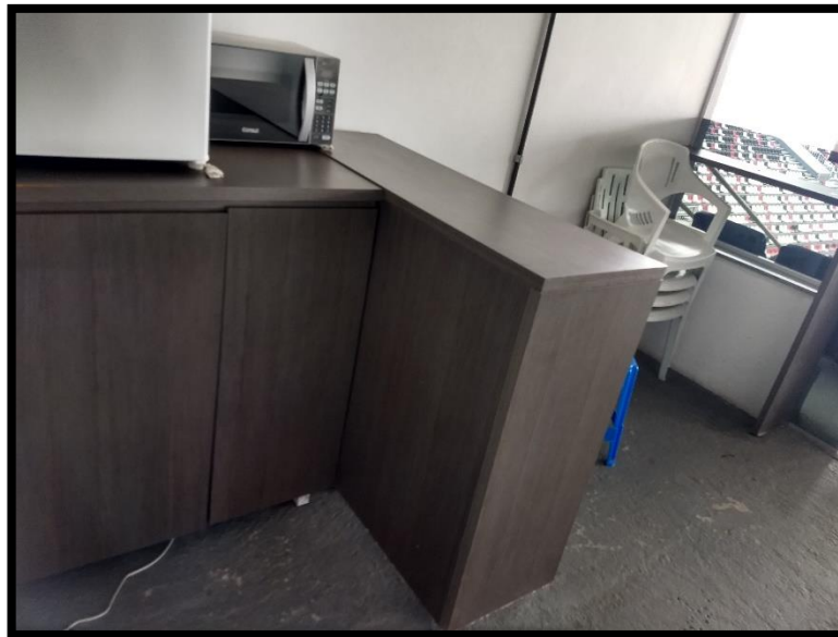
FOTO 36. Parede oeste camarote 19.
