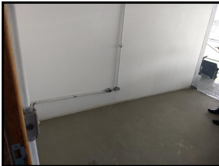
FOTO 12. Parede oeste camarote 8.
