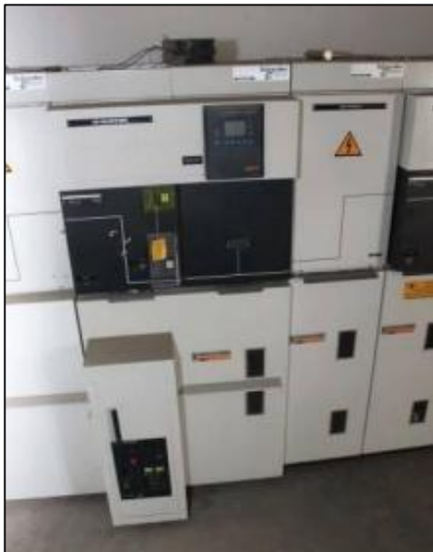
Figura 26: Painéis da subestação de energia do empreendimento.
