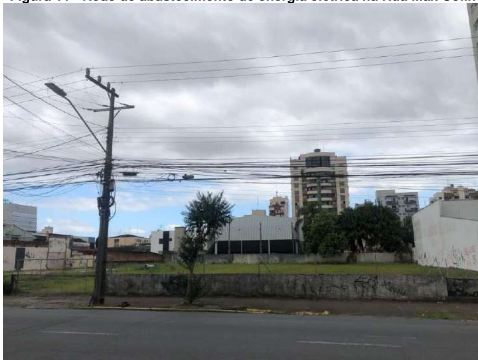
Figura 11 - Rede de abastecimento de energia elétrica na Rua Max Colin
