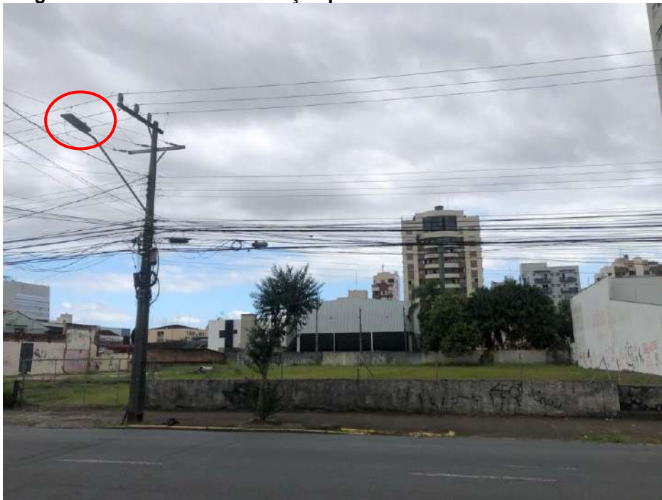
Figura 10 - Sistema de iluminação pública localizada na Rua Max Colin
