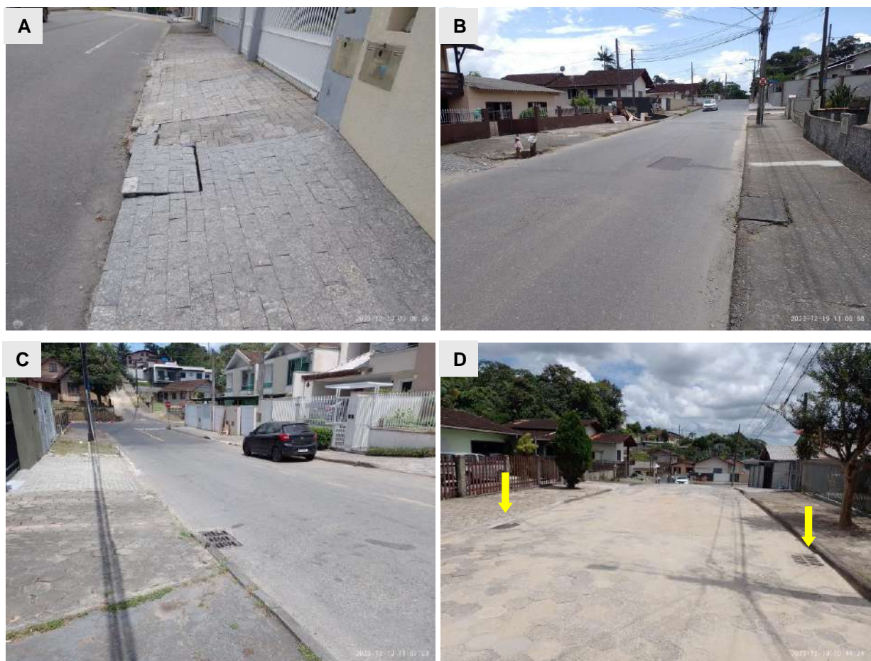
Figura 22: Bocas de lobo A: rua Olaria, próximo à rua Copacabana; B e C: rua Farroupilha; D: Servidão Manoel Behnke.
