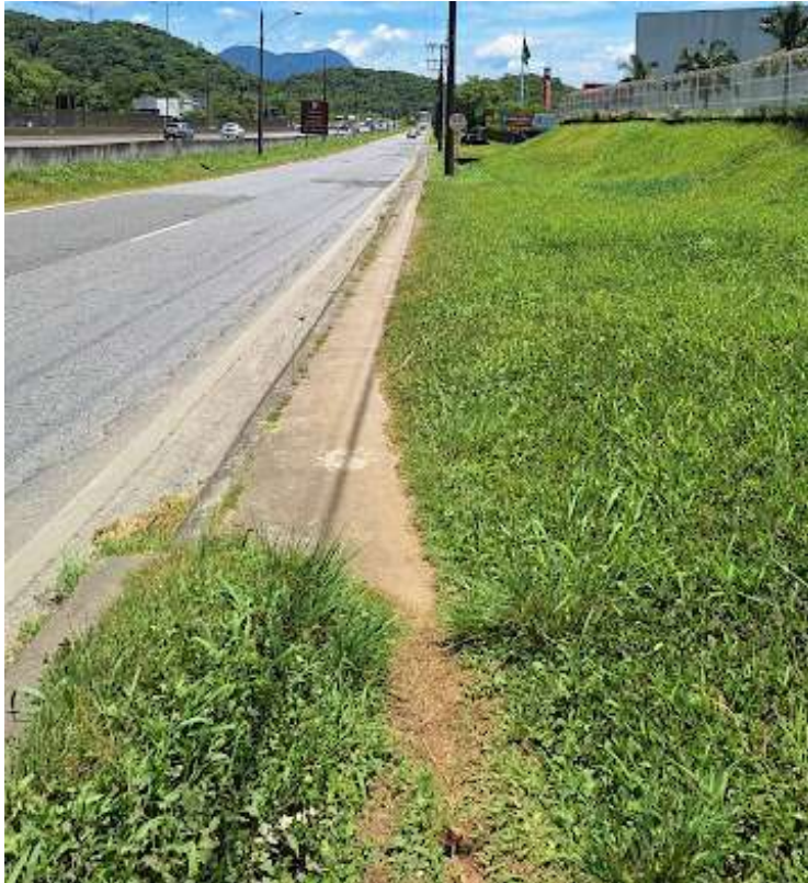
Figura 18 – Trechos com descontinuidade de calçada na marginal da BR-101
