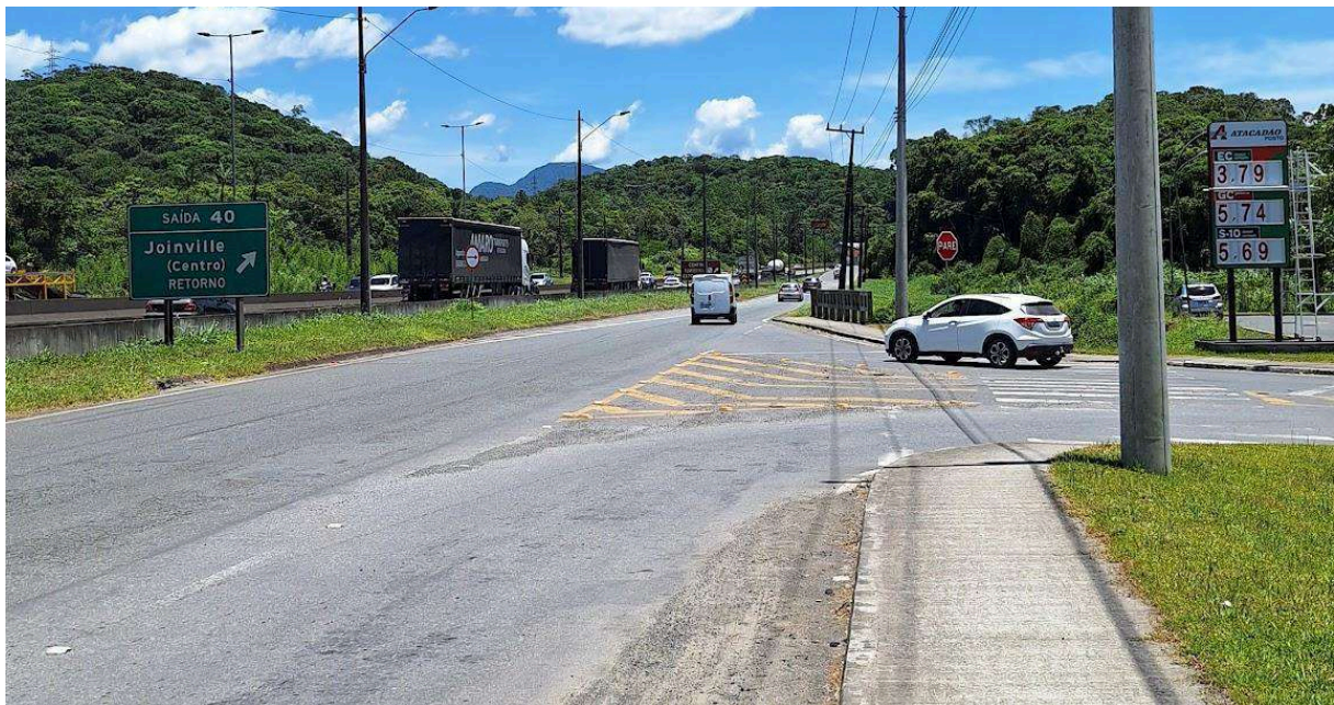
Figura: Condição da sinalização horizontal. Fonte: M.URB, 2023.
