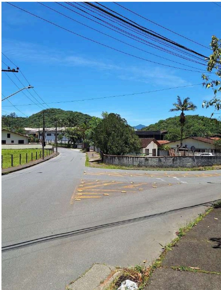
Figura 17 – Falhas na pintura da intersecção entre a Rua Colon e Rua Angelo Storrer
