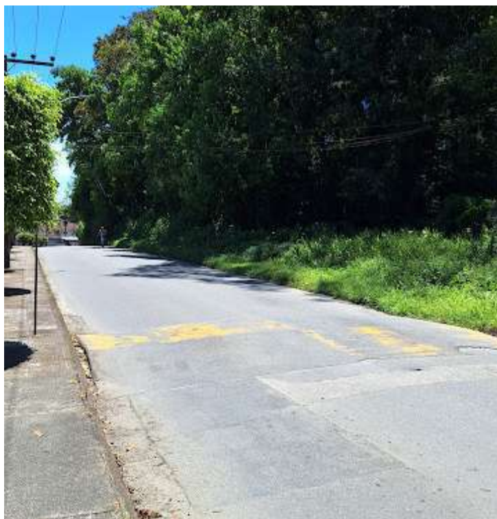
Figura 16 – Falhas na pintura na lombada da Rua Colon
