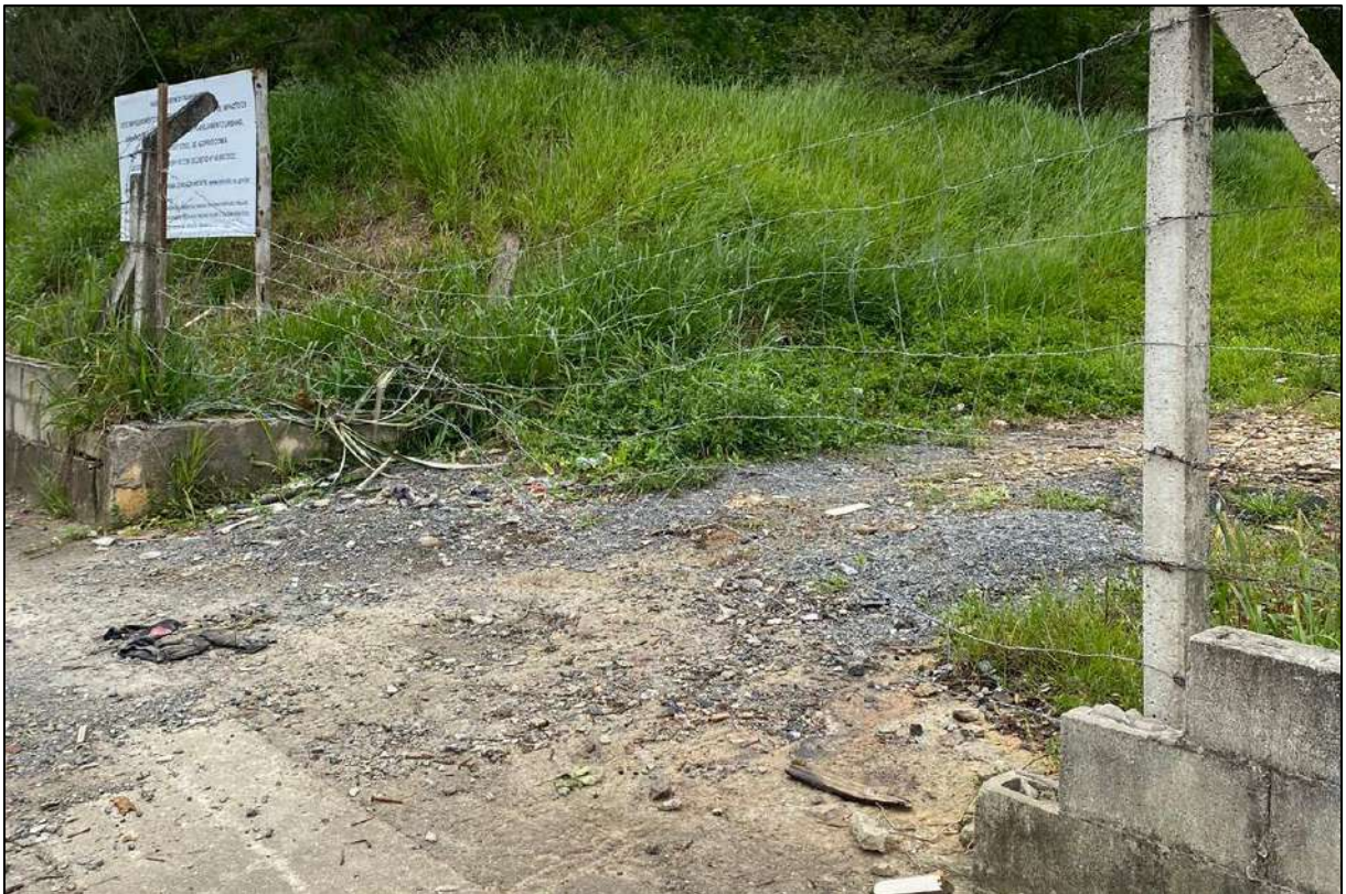
Figura 29. Cerca de acesso ao imóvel degradada evidenciado no local de estudo. Aos fundos placa de sinalização do pedido de Protocolo do EIV junto à SEPUR. Fonte: DBio, 2023.
