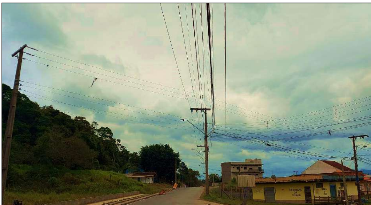
Figura 40: Rede elétrica passando pela área de influência do imóvel em estudo. Autor: DBio, 2021.
