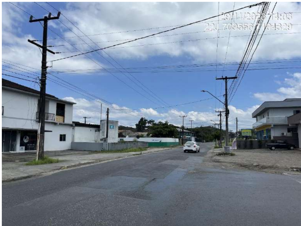
Figura 23: Iluminação pública na rua 15 de outubro.
