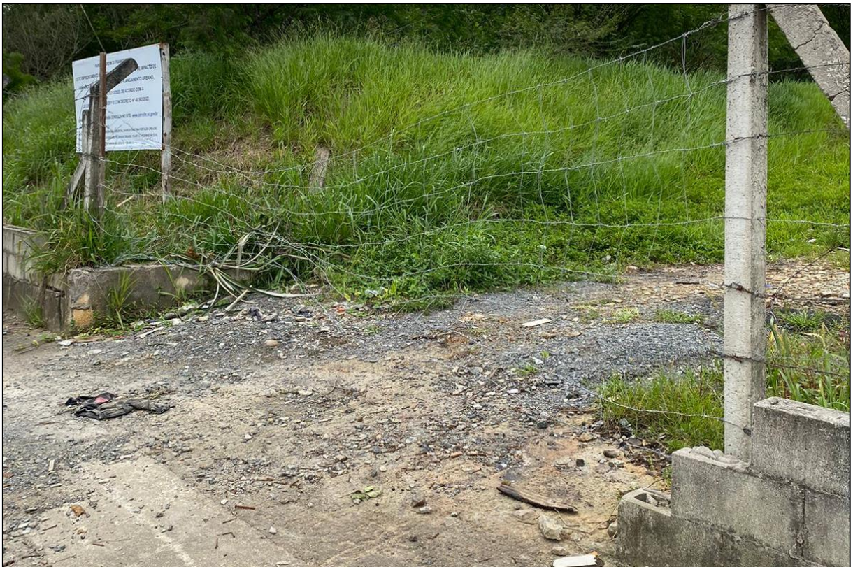
Figura 46. Cerca de acesso ao imóvel degradada evidenciado no local de estudo. Aos fundos placa de sinalização do pedido de Protocolo do EIV junto à SEPUR. Fonte: DBio, 2023.
