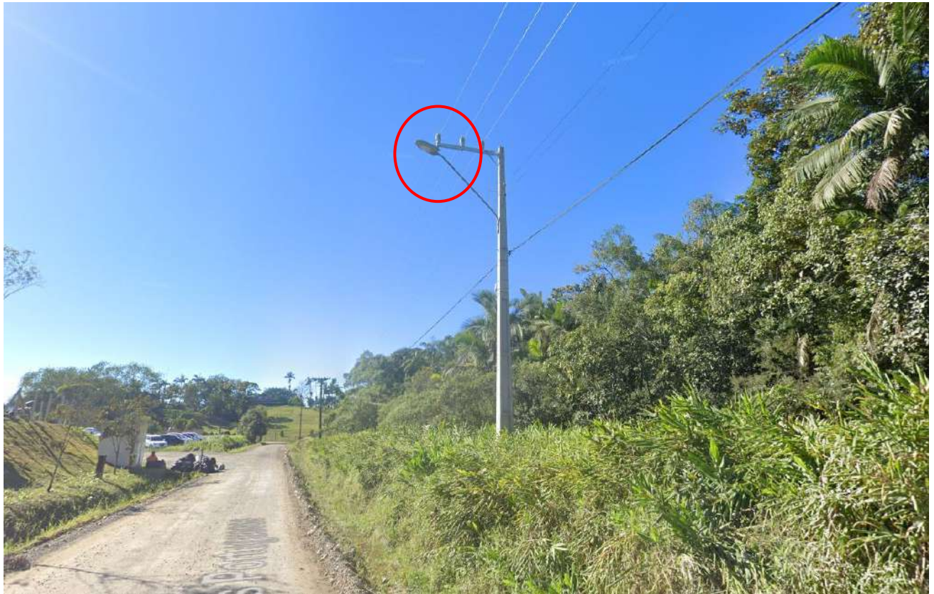
Figura 41- Sistema de iluminação pública localizada na Rua dos Portugueses.
