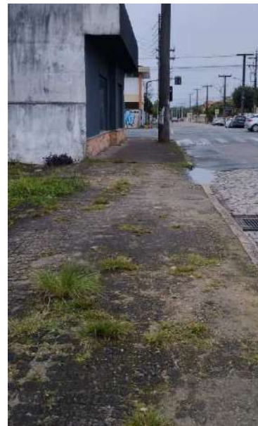
Calçada antiga com imperfeições e sem mureta guia ou piso tátil para acessibilidade
