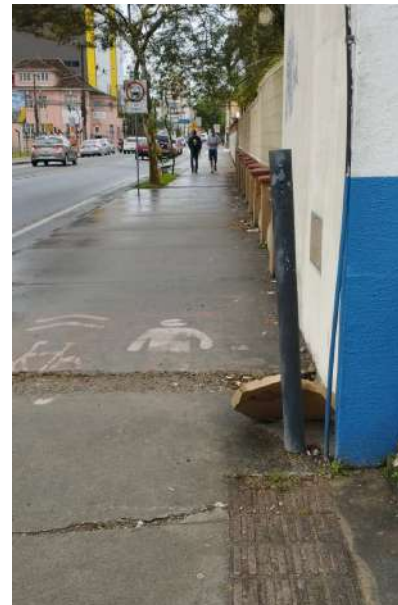
Calçada com rompimento do concreto para passagem de infraestrutura e sem recomposição. Piso tátil direciona para continuidade em guia de parede, porém pilar metálico obstrui a passagem para a pessoa com deficiência visual.
