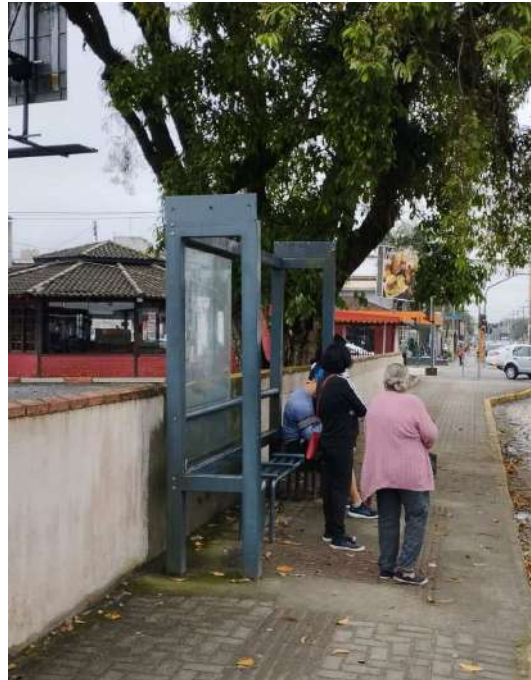
Abrigo de ônibus sem cobertura
