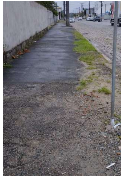
Calçada com pavimento danificado
