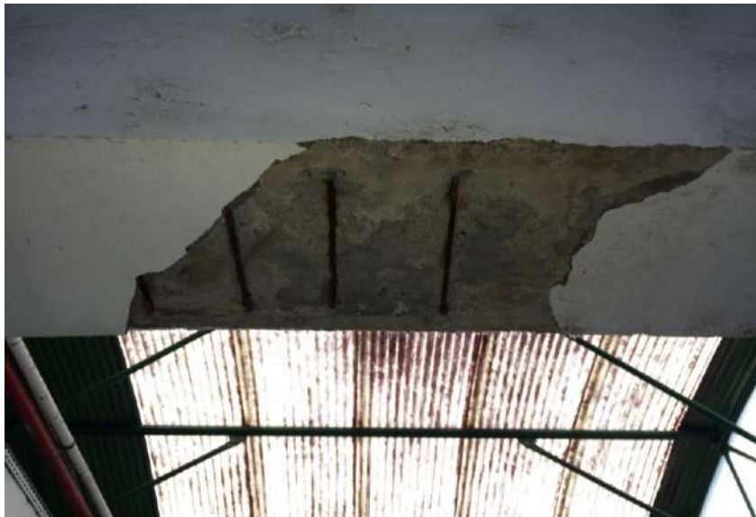
Imagem 01: Ponto comprometido na viga
