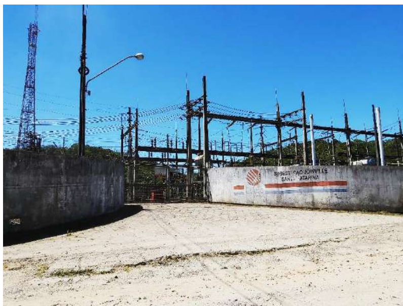
Figura 20: Vista frontal da Subestação Joinville Santa Catarina, limítrofe a Rua Ronco d'água.
