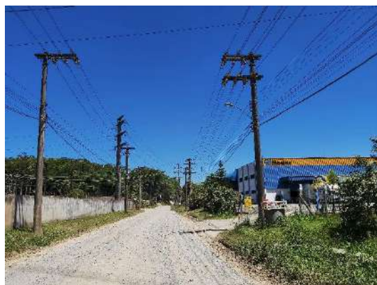
Figura 19: Rua Santa Catarina acesso da Subestação Joinville Santa Catarina.
