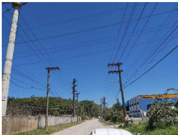
Figura 59: Postes no entorno da subestação Joinville Santa Catarina.
