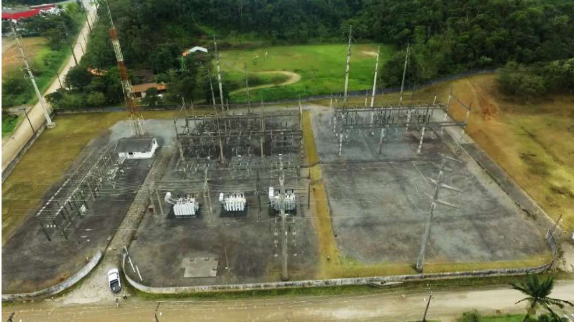
Figura 17: Ponto de chegada na SE Joinville Santa Catarina, de propriedade da CELESC.
