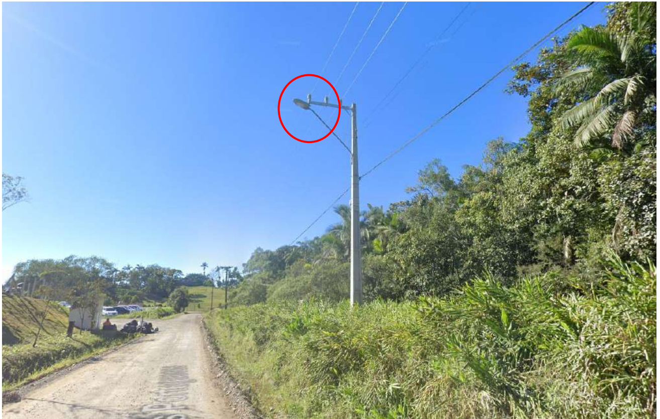
Figura 35- Sistema de iluminação pública localizada na Rua dos Portugueses.
