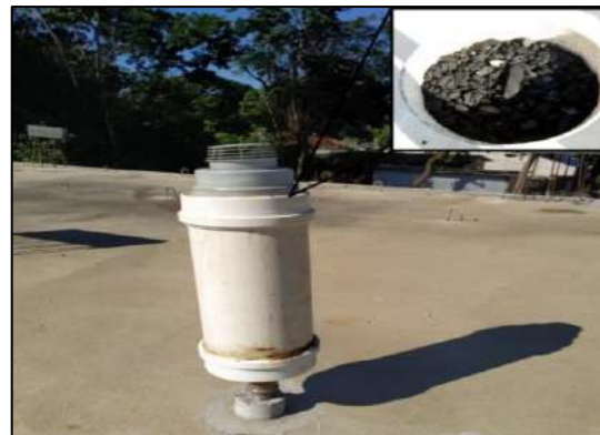
Figura 20. Parte superior do sistema de Filtração de e gases (Cemitério Vertical de Maringá) Fonte: Doré Engenharia, 2020
