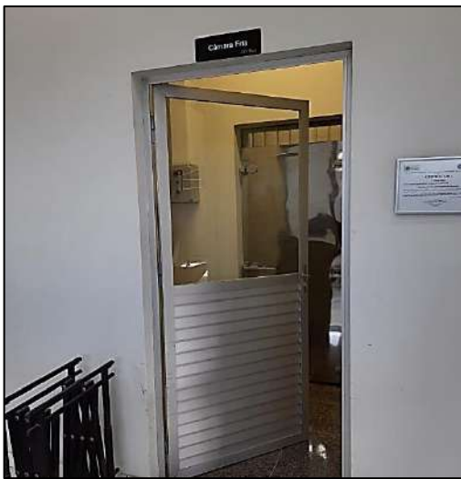
Figura 7. Câmara Fria Fonte: Doré Engenharia, 2022.
