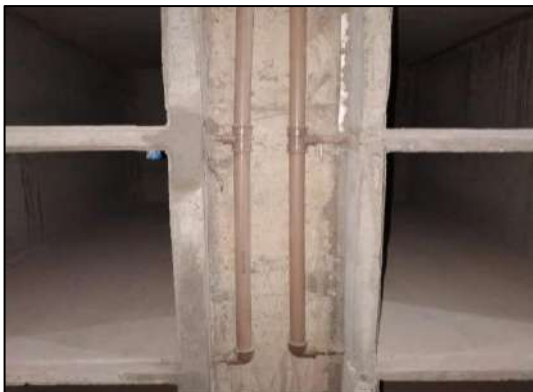
Figura 19. Sistema de filtração de gases (Cemitério Vertical de Maringá) Fonte: Doré Engenharia, 2020
