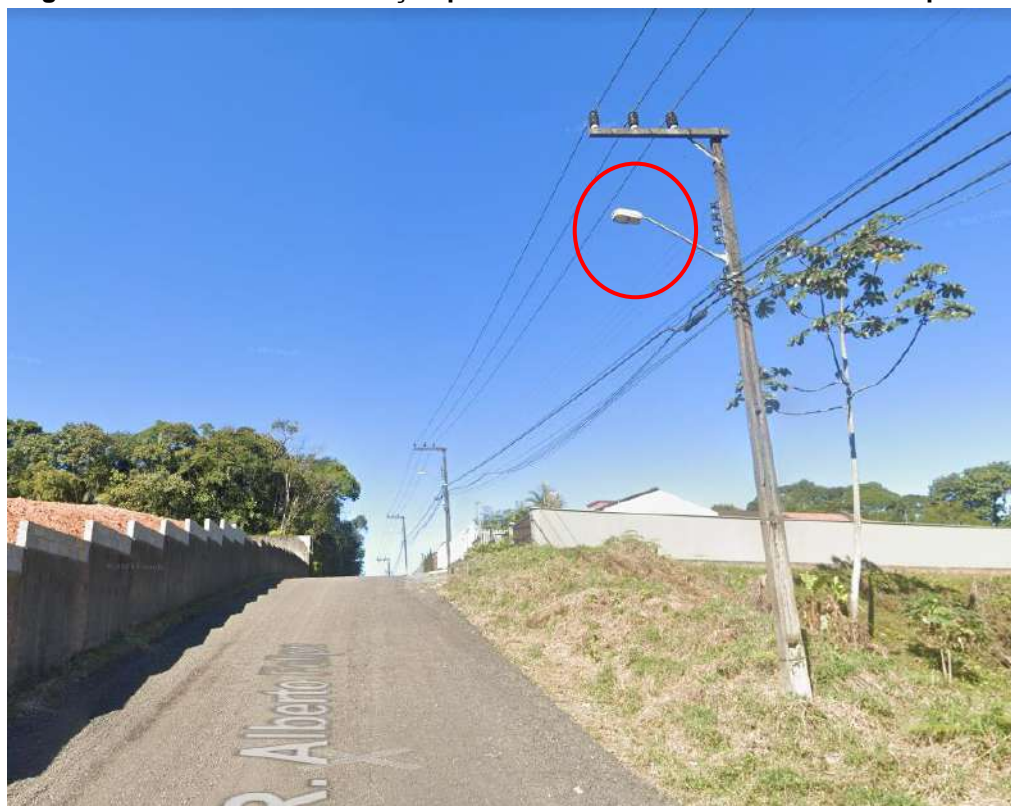
Figura 44- Sistema de iluminação pública localizada na Rua Alberto Felipe.
