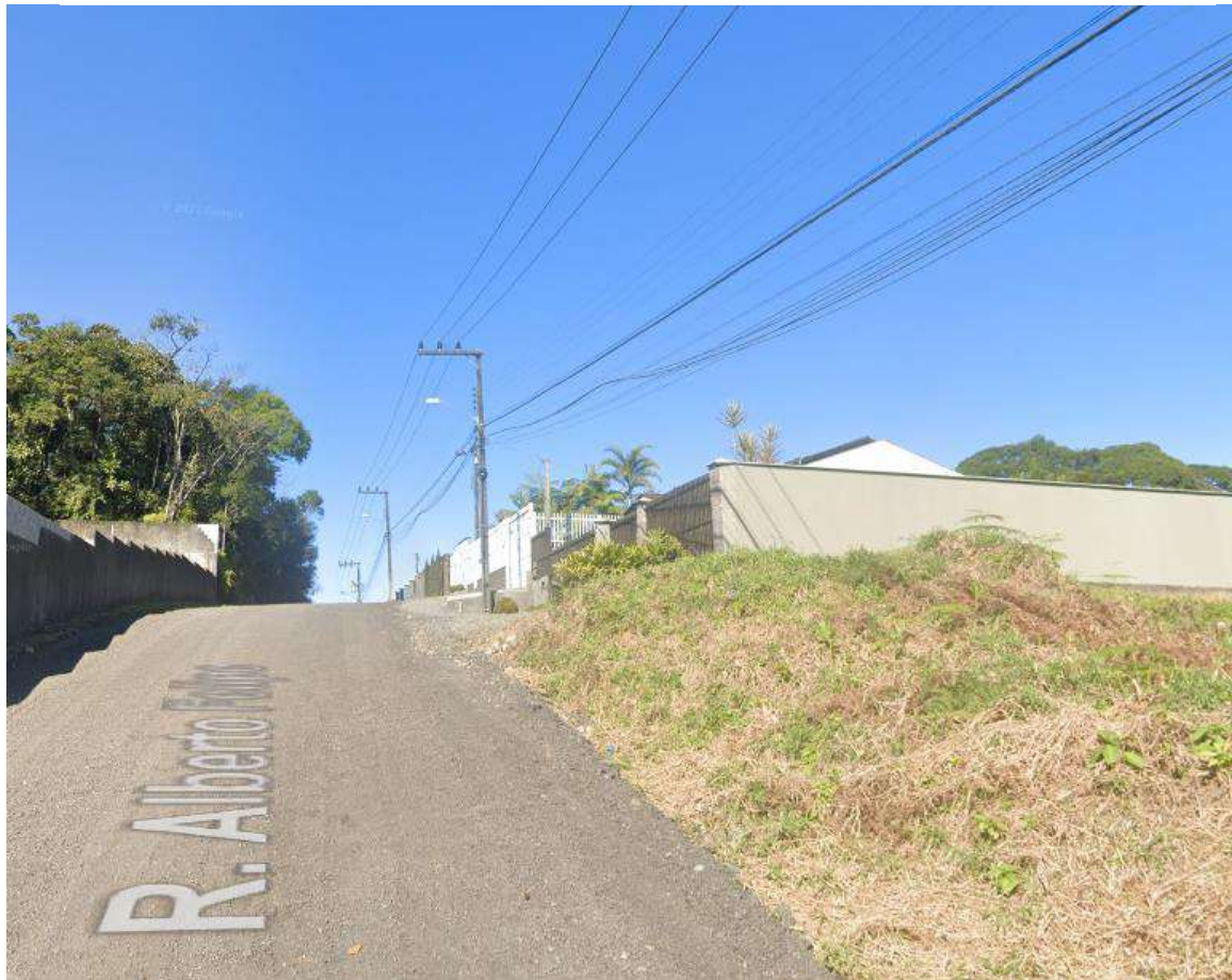
Figura 40- Rede de abastecimento de energia elétrica na Rua Alberto Felippi.
