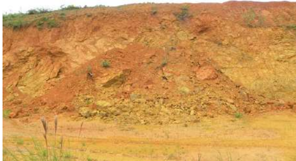
Foto 2-83: Detalhe de escorregamento circular envolvendo solo superficial (argissolo) e rocha saprolítica, em função de corte subvertical efetuado no terreno, associado a morro baixo, na região de Pedra de Amolar, município de Corupá/SC. Coord.: 22 J 676683 m E 7073999 m S.
