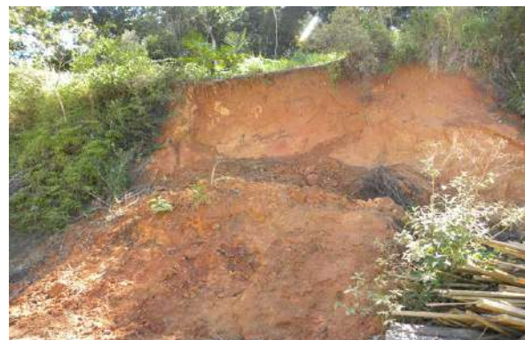
Foto 2-82: Detalhe de escorregamento circular, com movimentação de solo e rocha saprolítica (ver volume acumulado ao pé do talude). Situação decorrente da exposição do material em talude de corte subvertical (modificando a condição natural), observado na região de São Brás, município de Navegantes/SC.22 J 717762 m E 7038797 m S.
