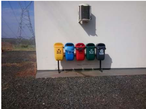
Foto 2-6: Exemplo de coletores seletivos de resíduos sólidos em um Subestação. Fonte: Acervo Dossel, 2012.
