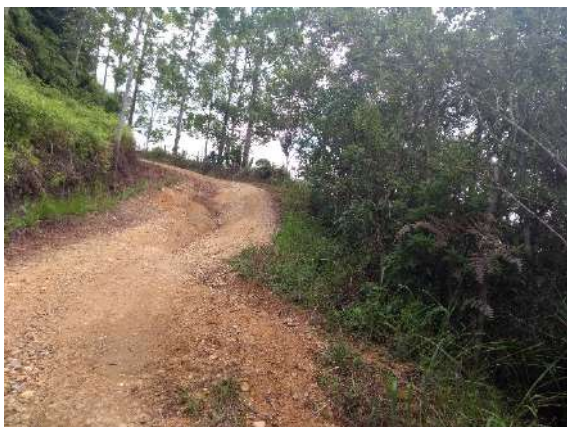
Foto 2-85: Feição erosiva em sulco se desenvolvendo em estrada na região serrana. Fonte: Acervo Dossel, 2019.
