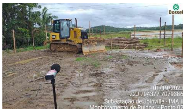
Foto 7-20: Ponto 02 do monitoramento de ruídos na SE Joinville Sul. Data: 19/01/2023.
