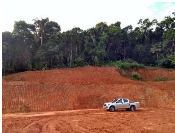
Foto 2-86: Talude de corte expondo o solo em área de terraplenagem a ser edificada na área de influência do empreendimento, no município de Blumenau/SC. Fonte: Acervo Dossel, 2019.
