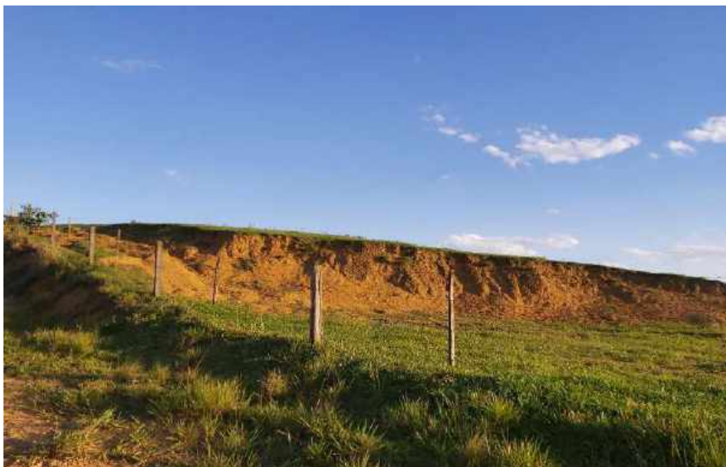
Figura 23: Talude de corte em propriedade registrada no trecho inicial do traçado, evidenciando a ocorrência de Argissolo Vermelho-Amarelo.
