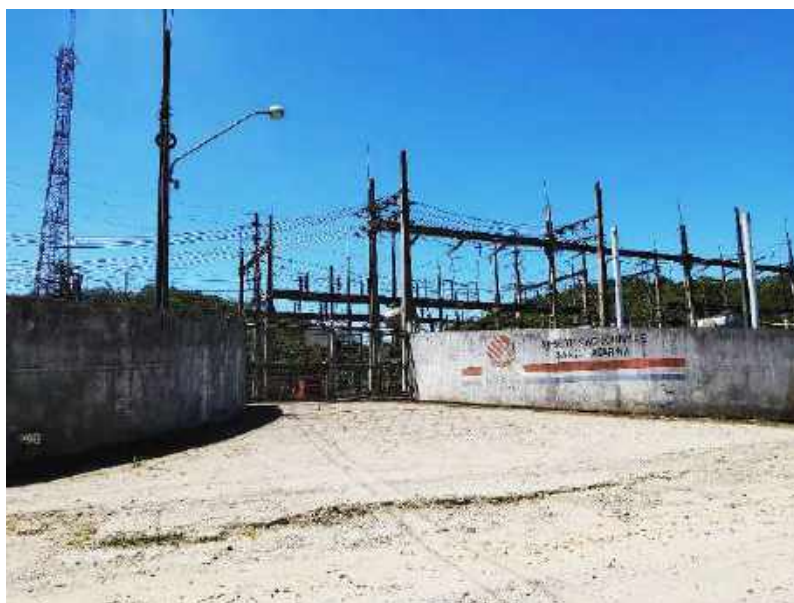
Figura 20: Vista frontal da Subestação Joinville Santa Catarina, limítrofe a Rua Ronco d'água.
