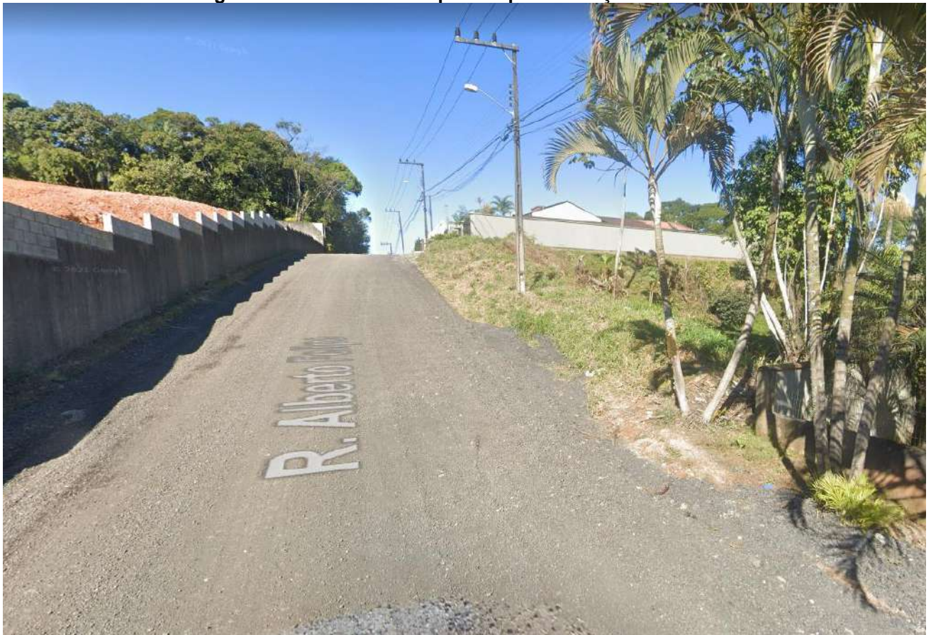
Figura 41- Rua Alberto Felipe sem pavimentação asfáltica.
