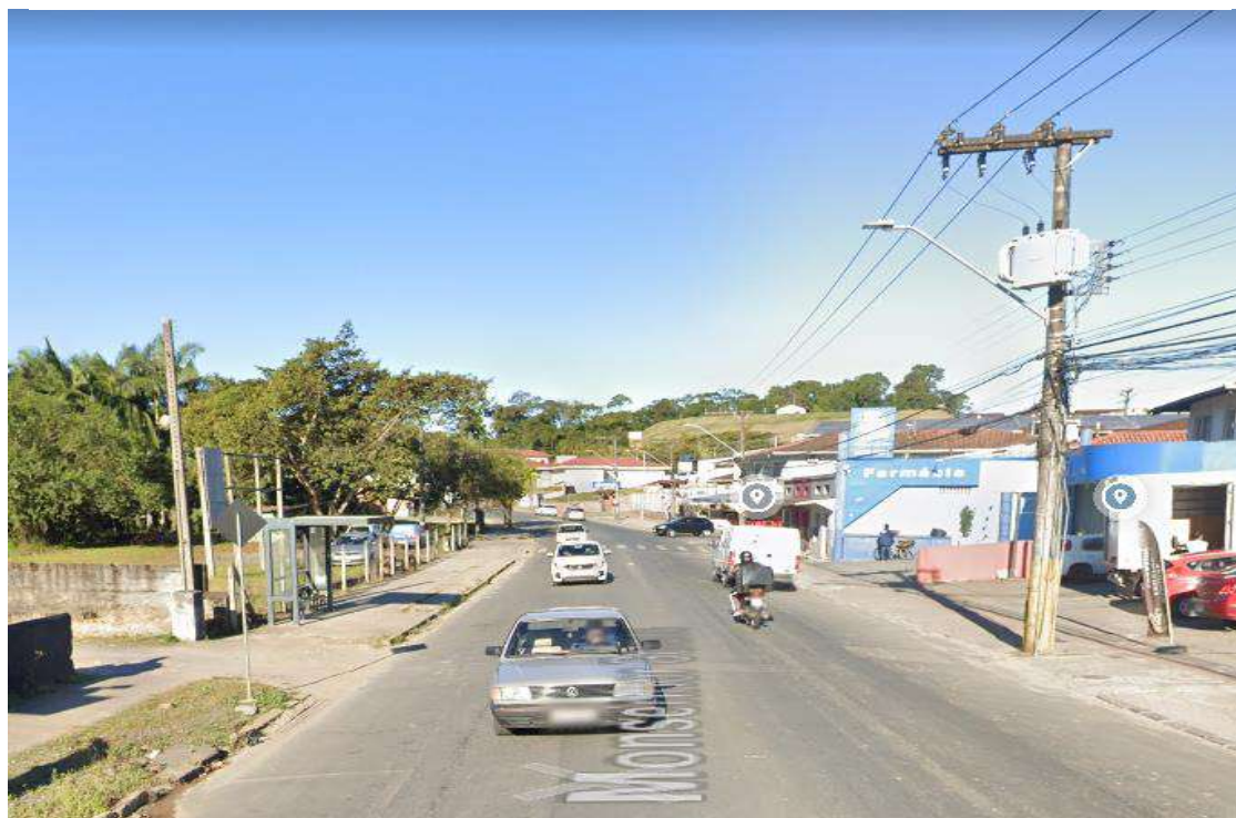
Figura 38- Rede de abastecimento de energia elétrica na Rua Monsenhor Gercino.
