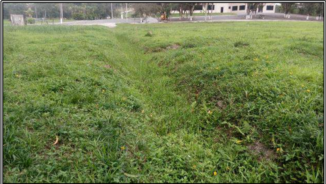
Figura 24: Vala de escoamento de caráter intermitente escavada para direcionar cargas hidráulicas para corpo hídrico à jusante
