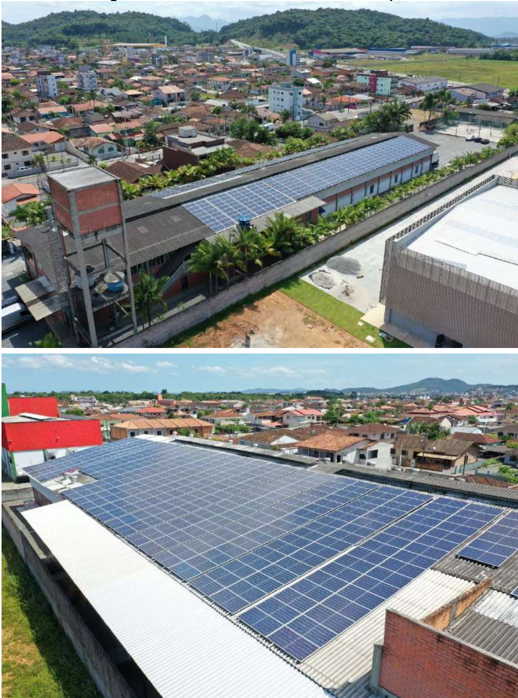
Figura 41 – Módulos solares instalados na empresa
