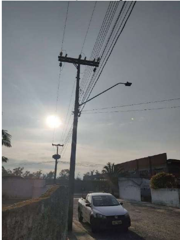
Figura 39 - Rede de distribuição de energia elétrica na Rua Jequié
