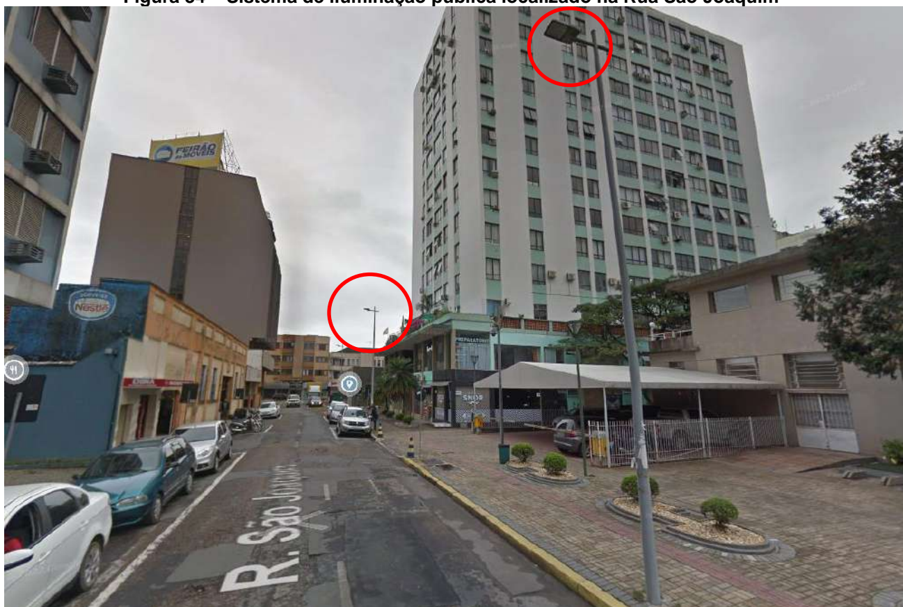
Figura 34 – Sistema de iluminação pública localizado na Rua São Joaquim
