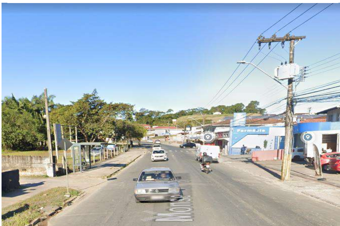
Figura 39- Rede de abastecimento de energia elétrica na Rua Monsenhor Gercino.
