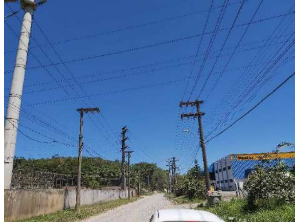
Figura 60: Postes no entorno da subestação Joinville Santa Catarina.
