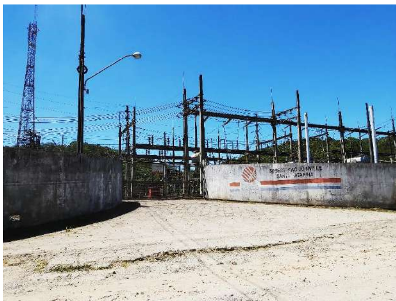
Figura 22: Vista frontal da Subestação Joinville Santa Catarina, limítrofe a Rua Ronco d'água.
