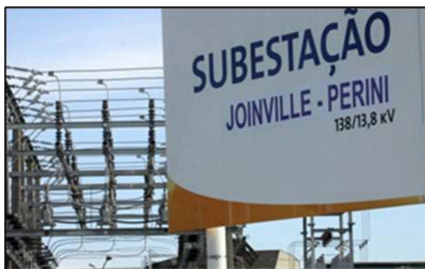
Figura 2.2: Subestação Joinville – Perini.
