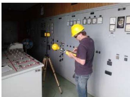
Foto 05: SE São Bento do Sul
