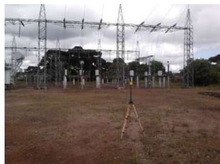
Foto 04: SE São Bento do Sul
