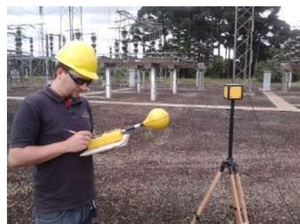
Foto 06: SE São Bento do Sul
