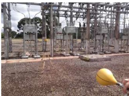
Foto 03: SE São Bento do Sul
