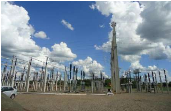
Vista Geral de estruturas implantadas em Subestação
